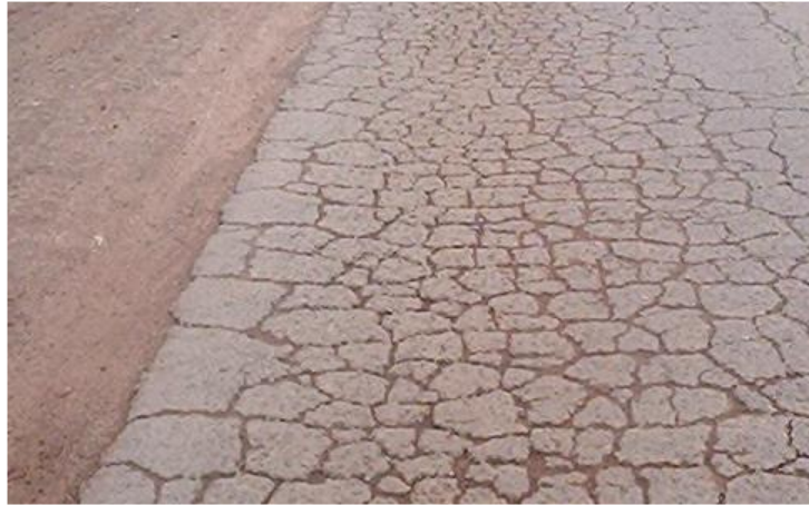
Figura 6 - Trincas no revestimento causado pelo efeito da água nas camadas do pavimento
