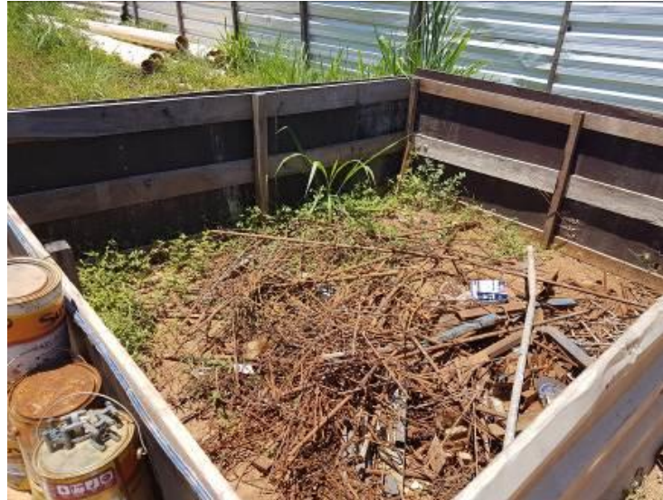
Figura 7: Material armazenado em local impróprio
