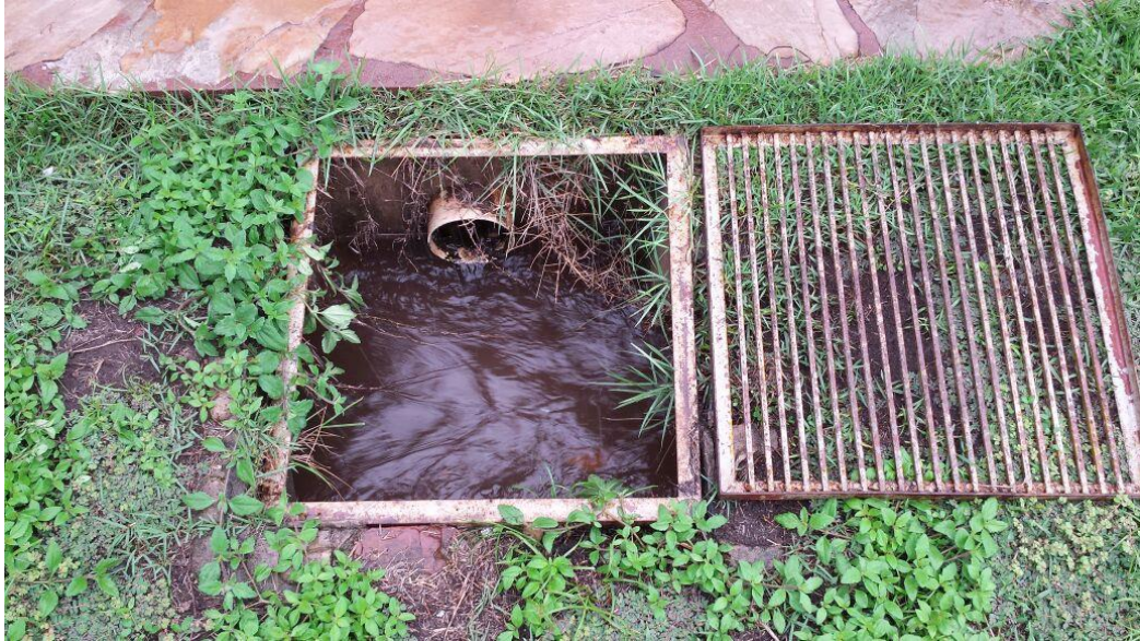
Figura 13 – Caixa de inspeção da recepção da água das calhas por cano PVC
