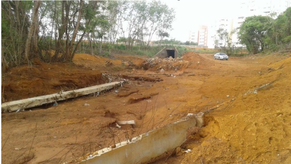
Figura 16 - Galeria de Água Pluvial
