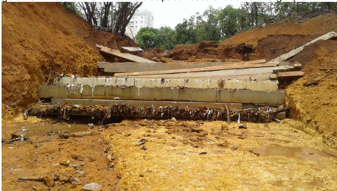
Figura 18 – Desmoronamento de dissipador escalonado de energia (13/11/2016)
