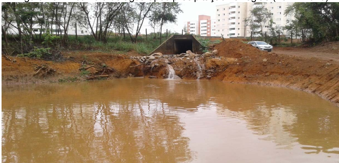
Figura 19 – Acúmulo de água após precipitação na região (13/11/2016)
