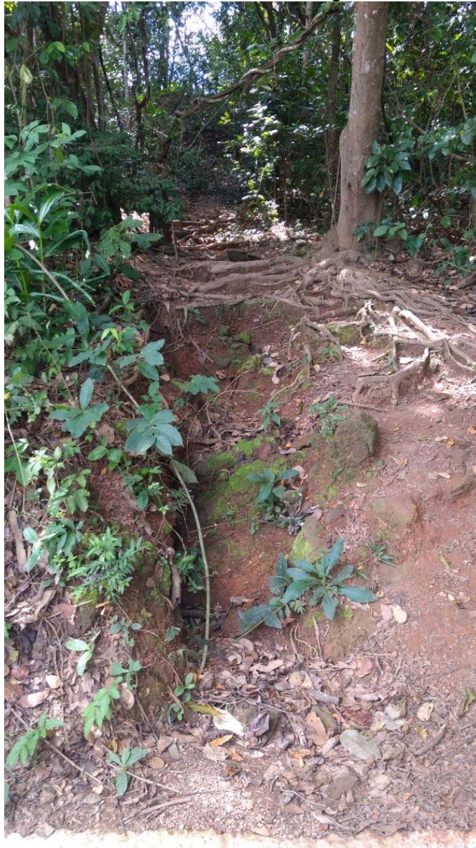
Figura 11 – Ponto 02 – Ponto de estágio inicial de erosão
