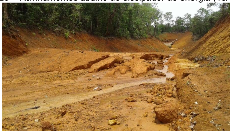
Figura 20 – Ravinamentos abaixo do dissipador de energia (13/11/2016)
