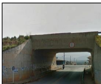
Figura 74-Condição do viaduto Aureny III
