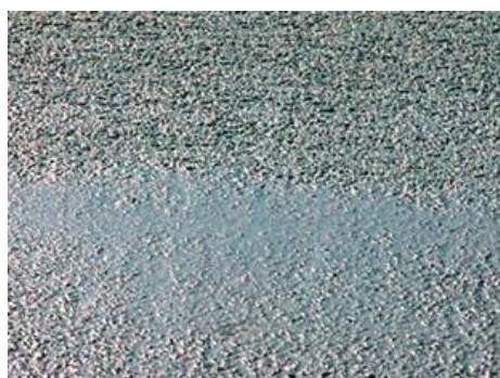
Figura 15- Detalhe de exsudação
