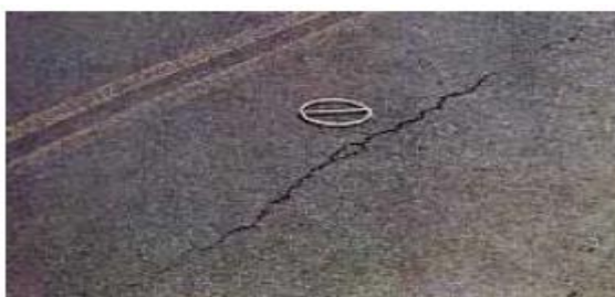
Figura 8– Foto trinca longitudinal
