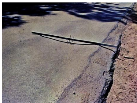
Figura 11– Foto do afundamento por consolidação nas trilhas de roda
