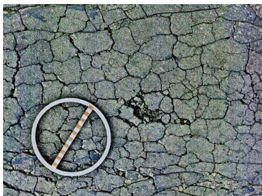
Figura 9– Foto trinca interligada tipo Jacaré
