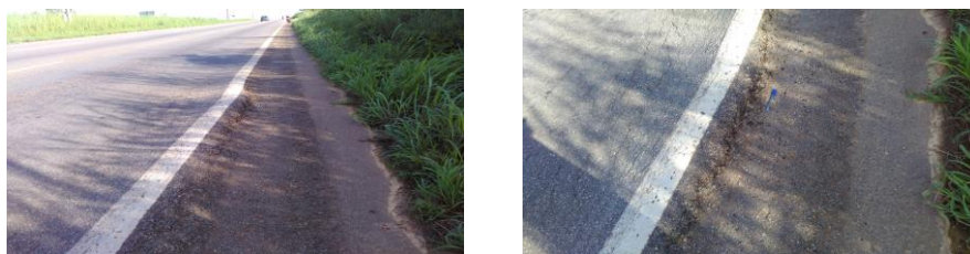
Figura 59-Ondulações e trincas interligadas
