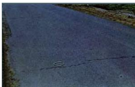
Figura 7 – Foto trinca transversal
