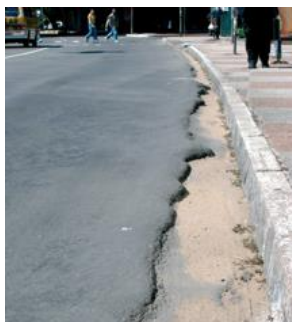
Figura 13– Escorregamento de massa
