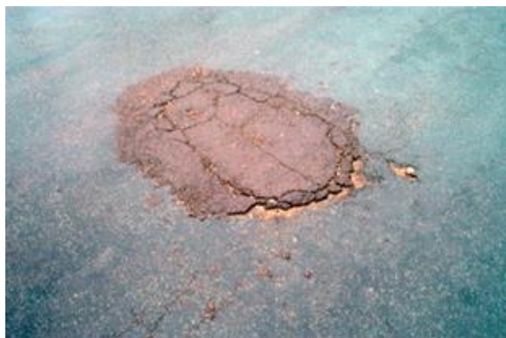
Figura 19– Remendo mal executado
