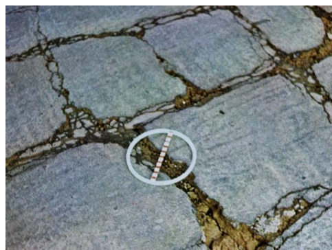
Figura 10– Foto do trincamento em blocos
