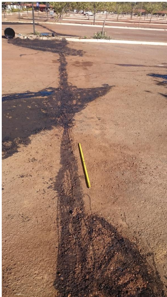
Figura 33 - Passagem de Tubulação Para Automação
