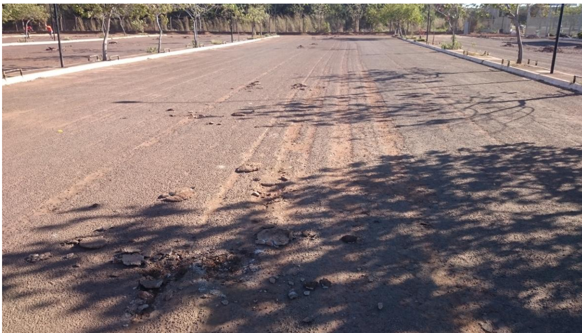
Figura 31 - Trincas Longitudinais em Evolução
