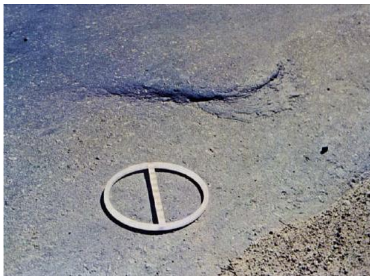
Figura 21 - Escorregamento do Revestimento
