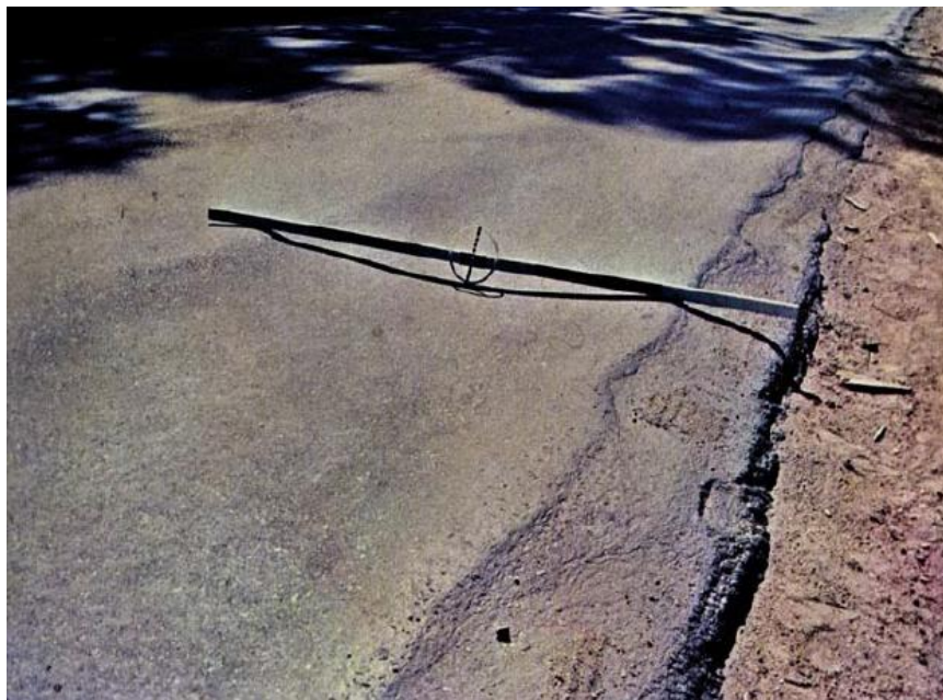
Figura 19 - Afundamento Trilhas de Roda
