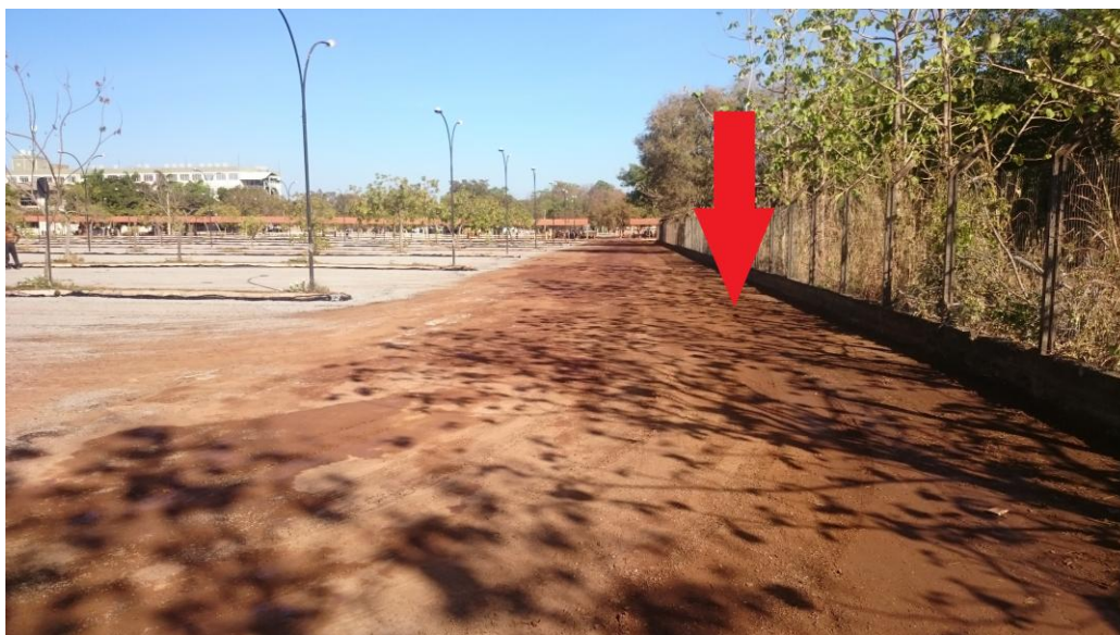
Figura 51 - Inexistência de Compactação e Impermeabilização
