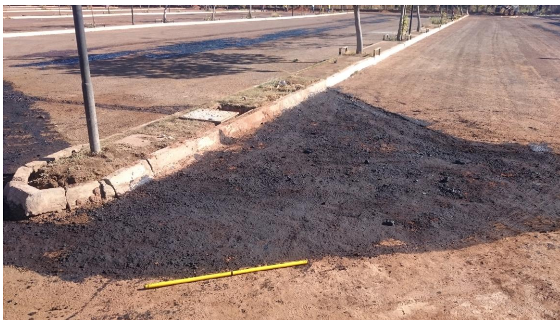
Figura 45 - Inexistência de Compactação nos Cantos dos Bolsões
