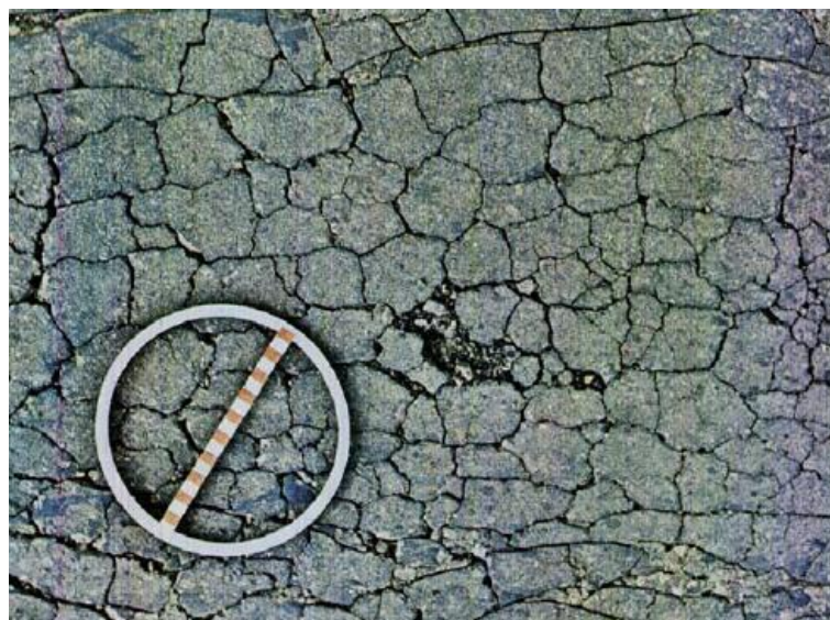
Figura 15 - Trinca Tipo "Couro de Jacaré"
