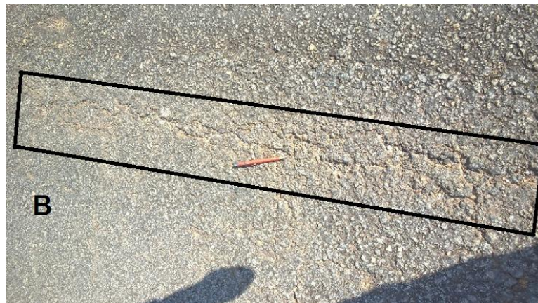
Imagem 05: Trinca longitudinal curta
