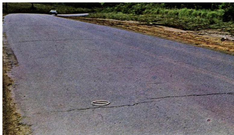
Figura 11: Trinca isolada – Transversal.
