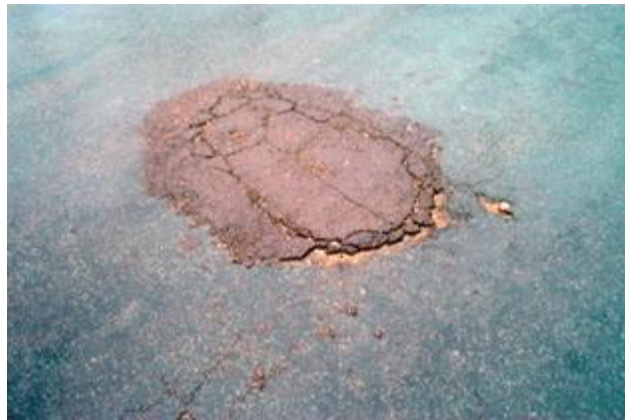
Figura 23: Remendo mal executado.
