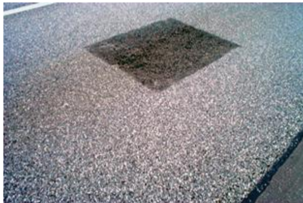
Figura 24: Remendo bem executado.
