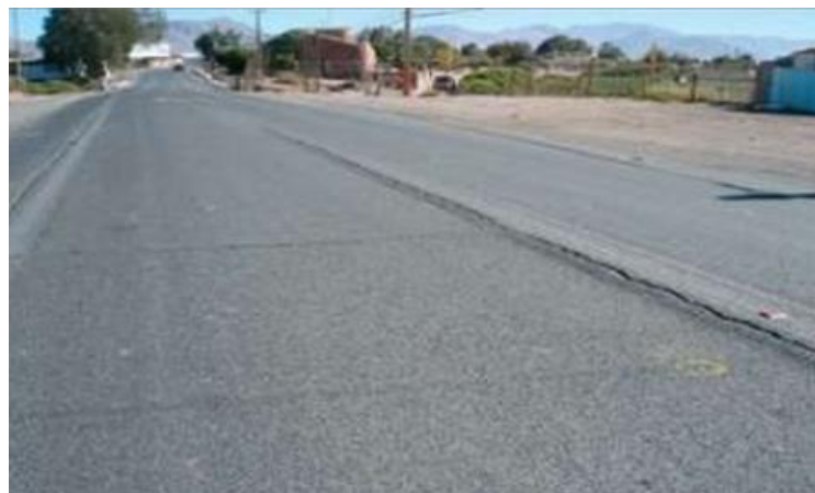
Figura 13: Trinca isolada – Retração.
