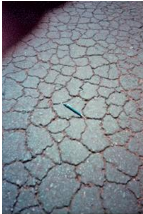
Figura 14: Trinca interligada – Tipo “couro de jacaré”.
