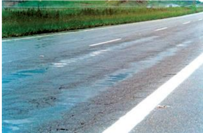
Figura 16: Afundamento de trilha de roda.
