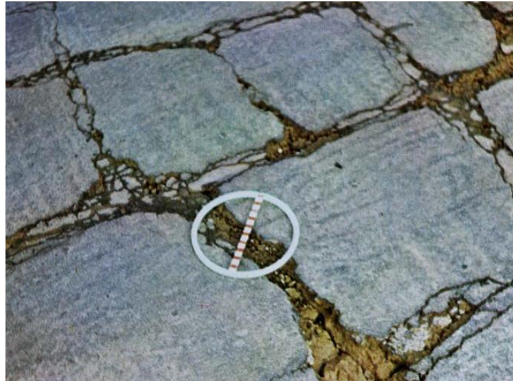
Figura 15: Trinca interligada – Tipo “bloco”.
