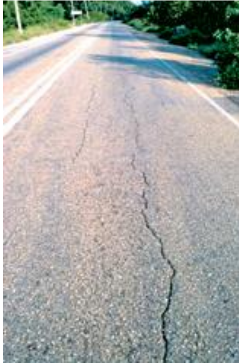
Figura 12: Trinca isolada – Longitudinal.
