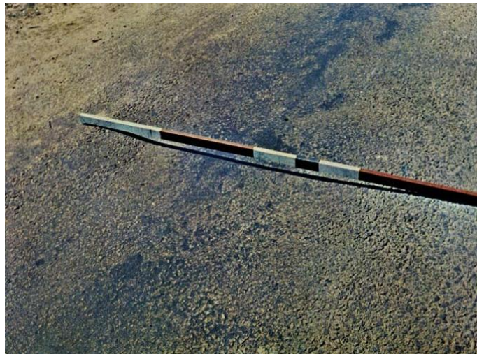
Figura 17: Afundamento de consolidação local.
