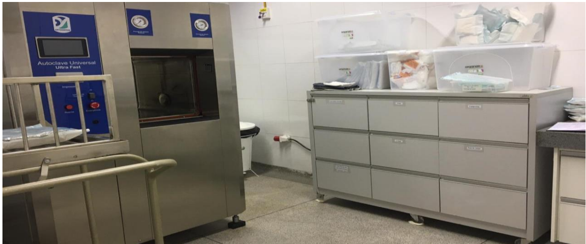
Figura 17 – Sala de esterilização do Hospital Veterinário do CEULP/ULBRA
