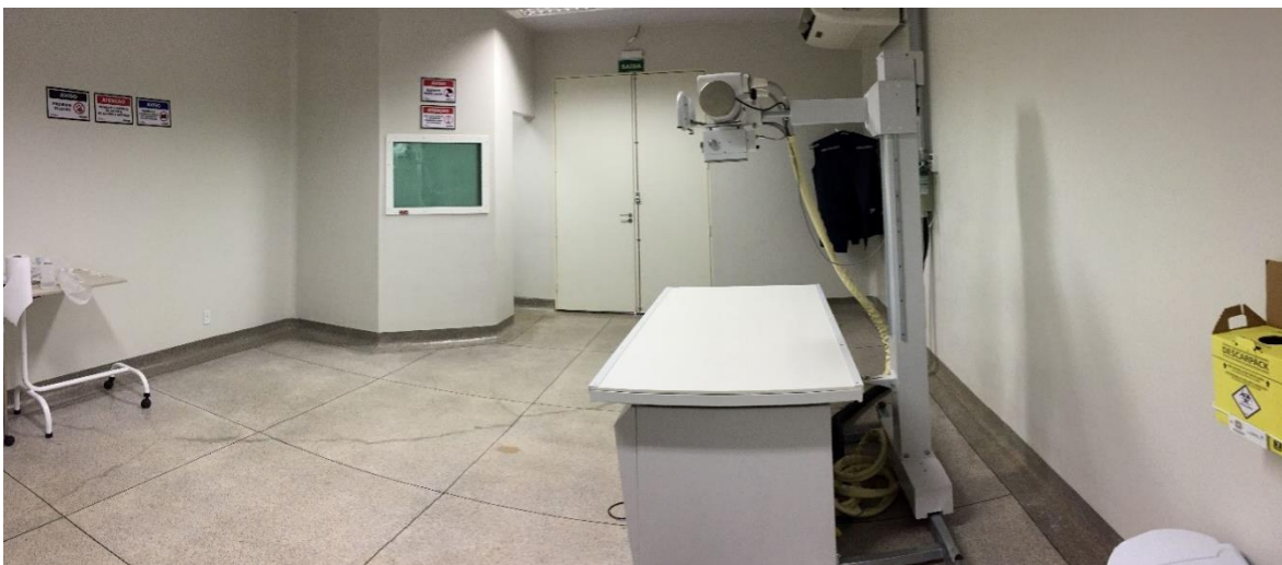
Figura 11 – Sala de Raio X do Hospital Veterinário do CEULP/ULBRA
