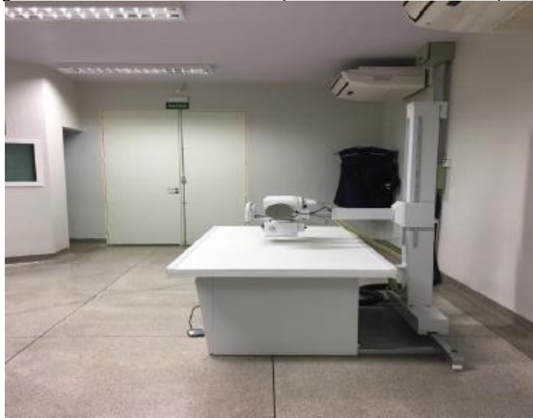
Figura 6 – Sala de Raio-x do Hospital Veterinário do Ceulp/UiBra
