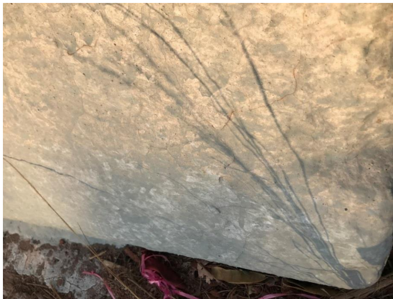
Figura 24 - Fissuras mapeadas no guarda rodas direito.
