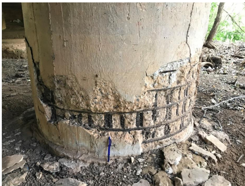
Figura 14 – Desagregação, deslocamento, cobrimento deficiente e corrosão da armadura do pilar 6.
