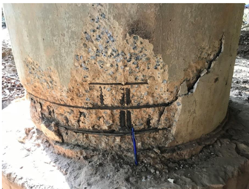
Figura 13 - Desagregação, deslocamento do concreto e corrosão das armaduras no pilar 4.
