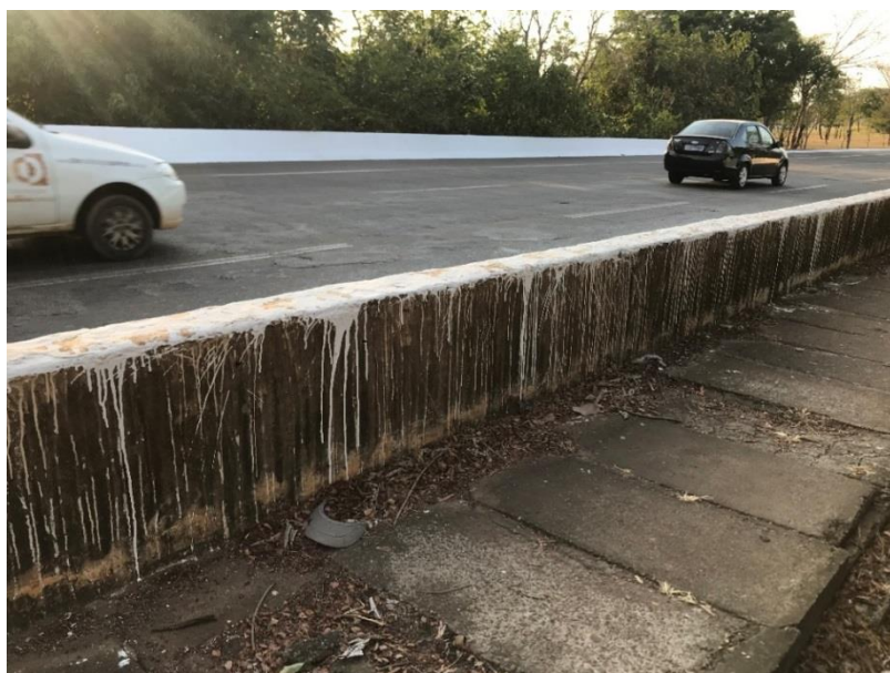
Figura 25 - Manchas de bolor no guarda rodas direito.
