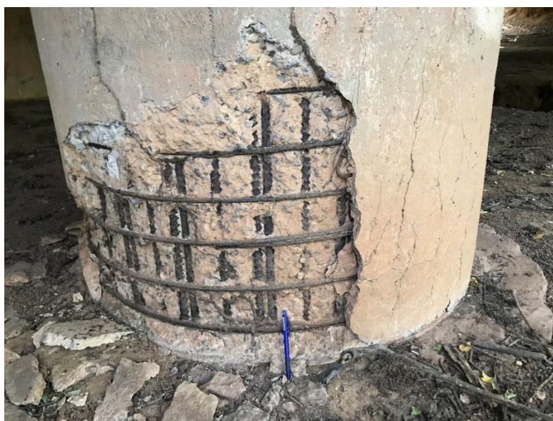
Figura 15 – Deslocamento do concreto, corrosão das armaduras e fissuras diagonais no pilar 6.
