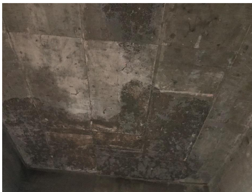
Figura 20 - eflorescência e infiltração de água na laje 8 (L8).
