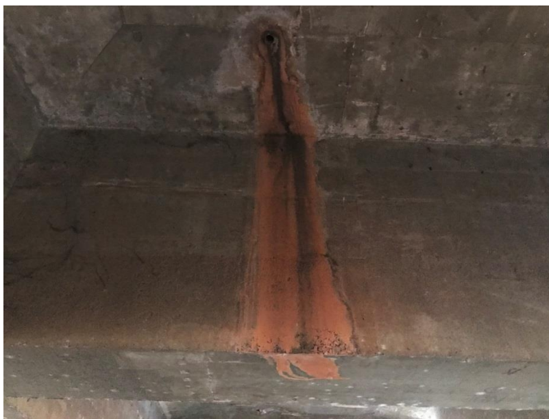
Figura 17 - Forte infiltração de água na viga transversina 6 (VT6).
