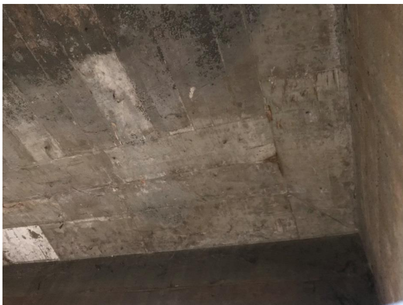
Figura 21 - corrosão de armadura, infiltração de água e eflorescência na laje 16 (L16).
