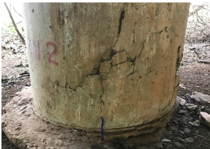
Figura 16 - Fissuras no pilar 6.
