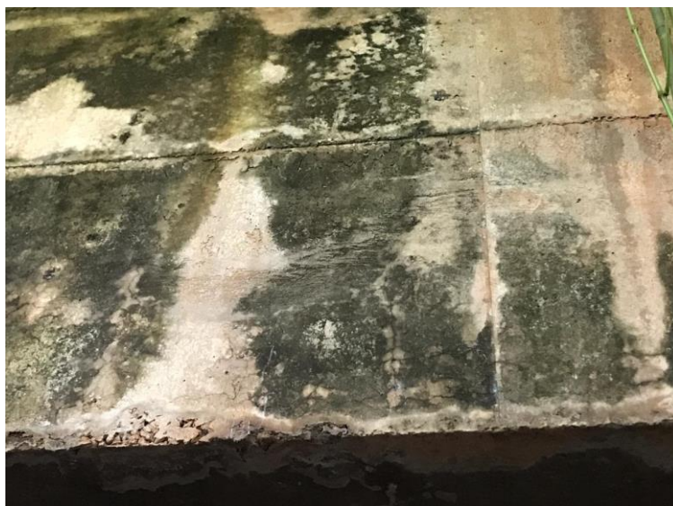
Figura 19 - Falhas de concretagem e manchas de bolor na viga longarina 4 (VL4).
