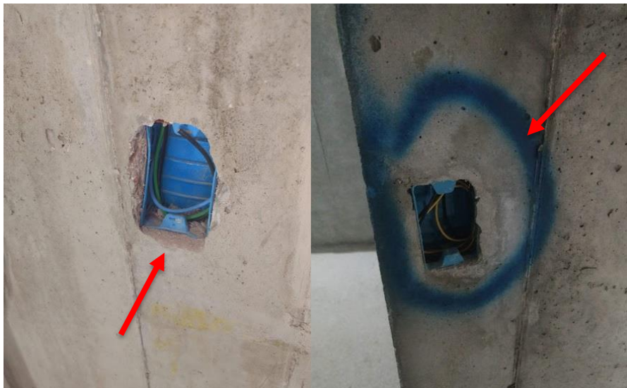
Figura 21 - Caixa 4x2 deslocada e submersa na parede.
