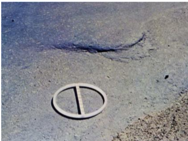
Figura 19 – Escorregamento Fonte: DNIT 005/2003
