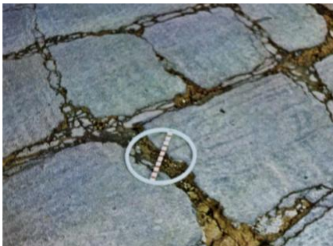
Figura 15 – Trinca Interligada Tipo Bloco Fonte: DNIT 005/2003
