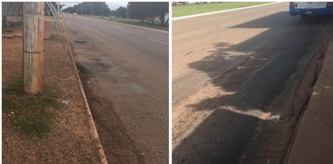
Figura 23 – Patologias das Estações Krahô e Xambioá Fonte: Acervo Pessoal (2019)
