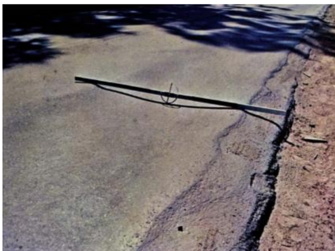
Figura 10 – Afundamento de Trilha de Roda Fonte: DNIT 005/2003
