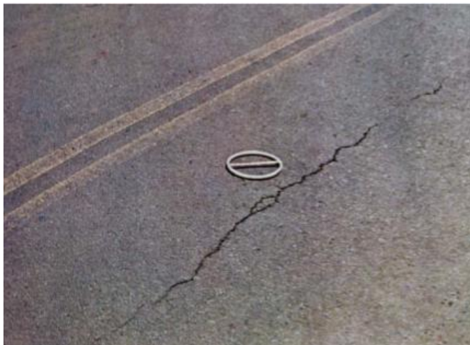
Figura 13 – Trinca Longitudinal Fonte: DNIT 005/2003
