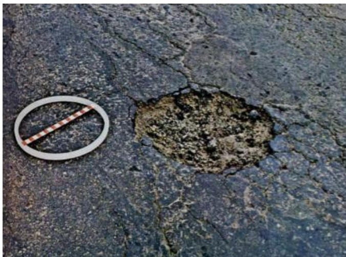
Figura 17 – Buraco/Panela Fonte: DNIT 005/2003
