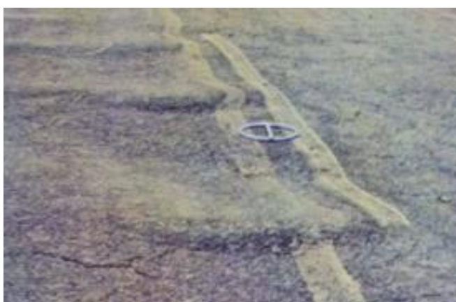
Figura 18 – Ondulação Fonte: DNIT 005/2003
