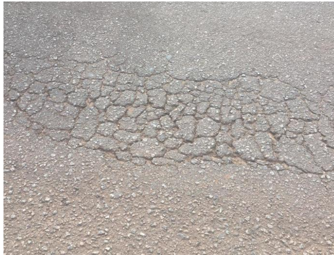
Figura 39 – Trinca Interligada Tipo Couro de Jacaré e Desgaste Fonte: Acervo Pessoal (2019)
