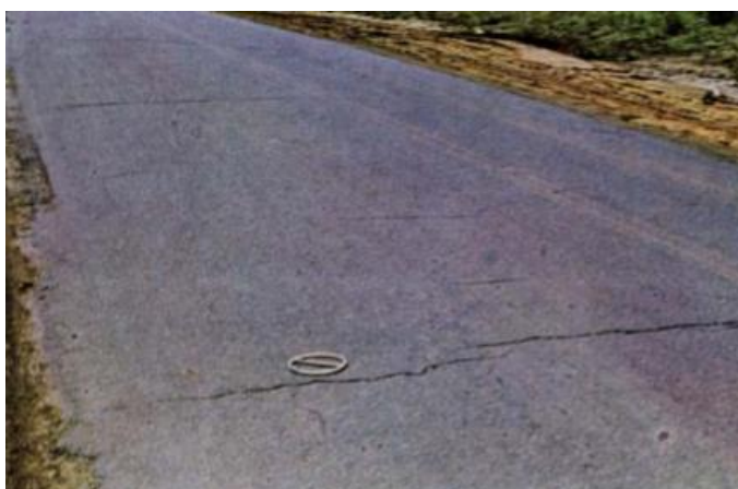
Figura 12 – Trinca Transversal Fonte: DNIT 005/2003
