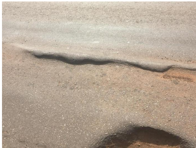
Figura 42 – Escorregamento do Revestimento Fonte: Acervo Pessoal (2019)
