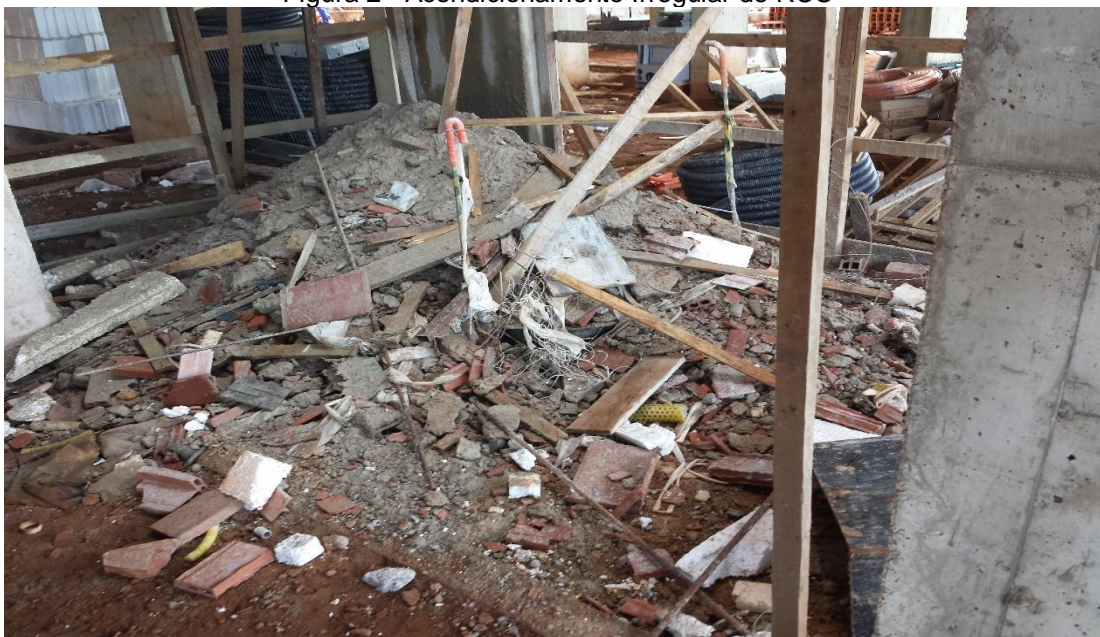
Figura 2 - Acondicionamento Irregular de RCC
