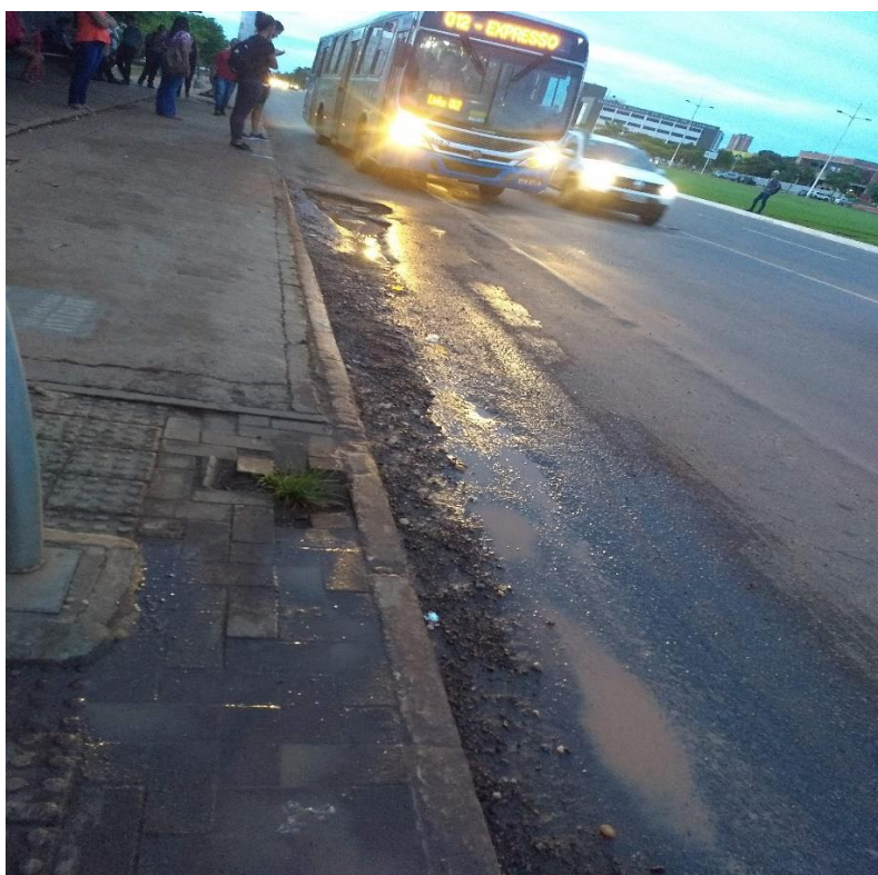
Figura 12 - Patologias na Estação Xambioá
