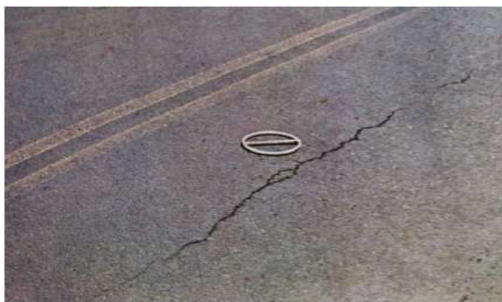
Figura 10– Trinca isolada: longitudinal
