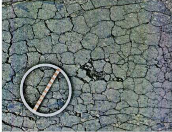
Figura 11– Trinca interligada: tipo jacaré
