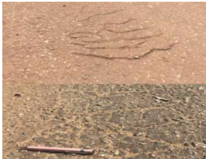
Figura 34- Trinca Couro de Jacaré
