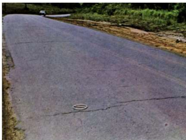
Figura 9– Trinca isolada: transversal
