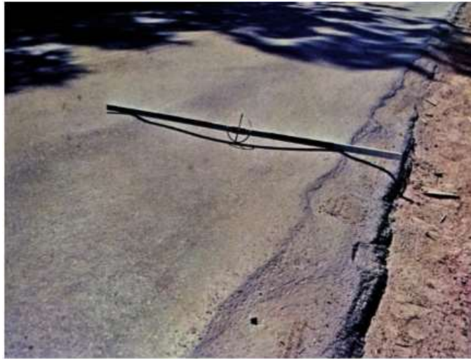
Figura 13– Afundamento de trilha de roda
