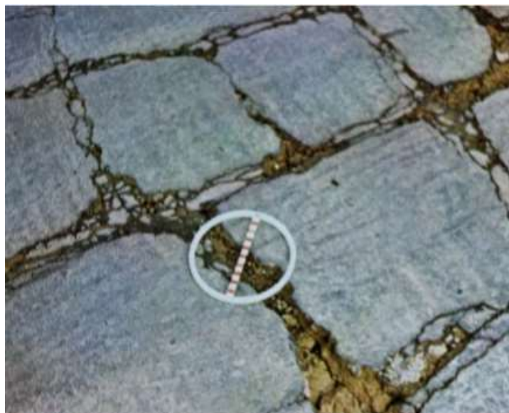
Figura 12– Trinca interligada: tipo bloco
