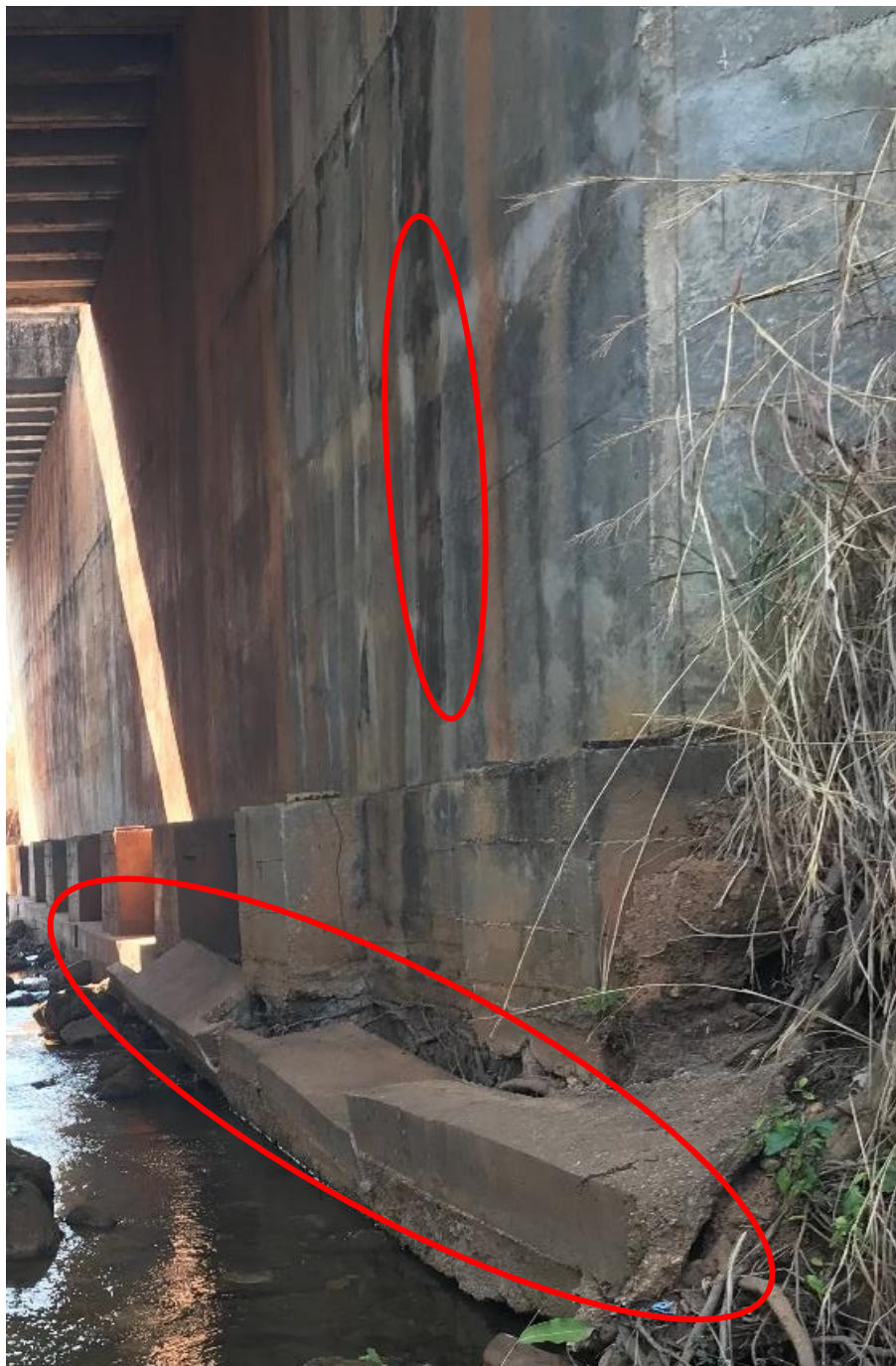
Figura 7 – Deslocamento da viga de travamento da infraestrutura e presença de bolor e eflorescência na Cortina Sul.
