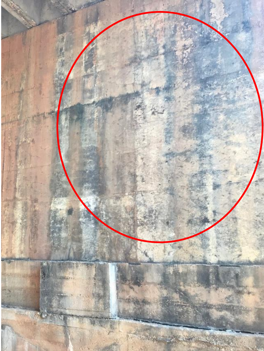
Figura 4 – Presença de bolor e eflorescência na Cortina Norte.
