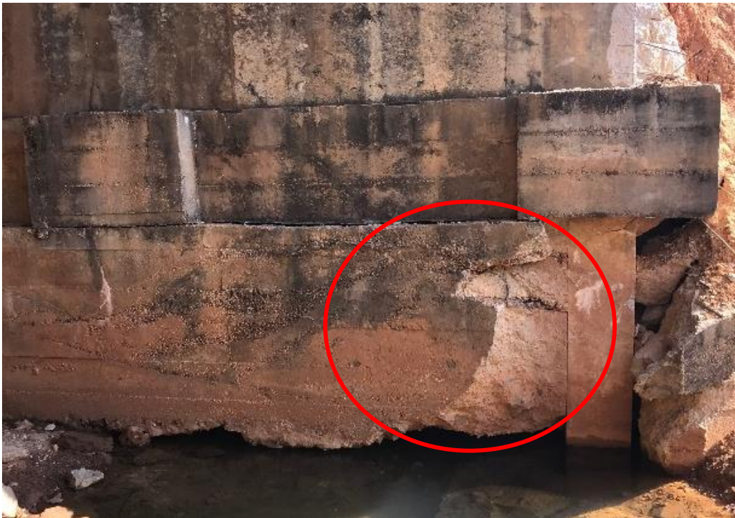
Figura 6 – Desplacamento do concreto da viga de travamento da infraestrutura.
