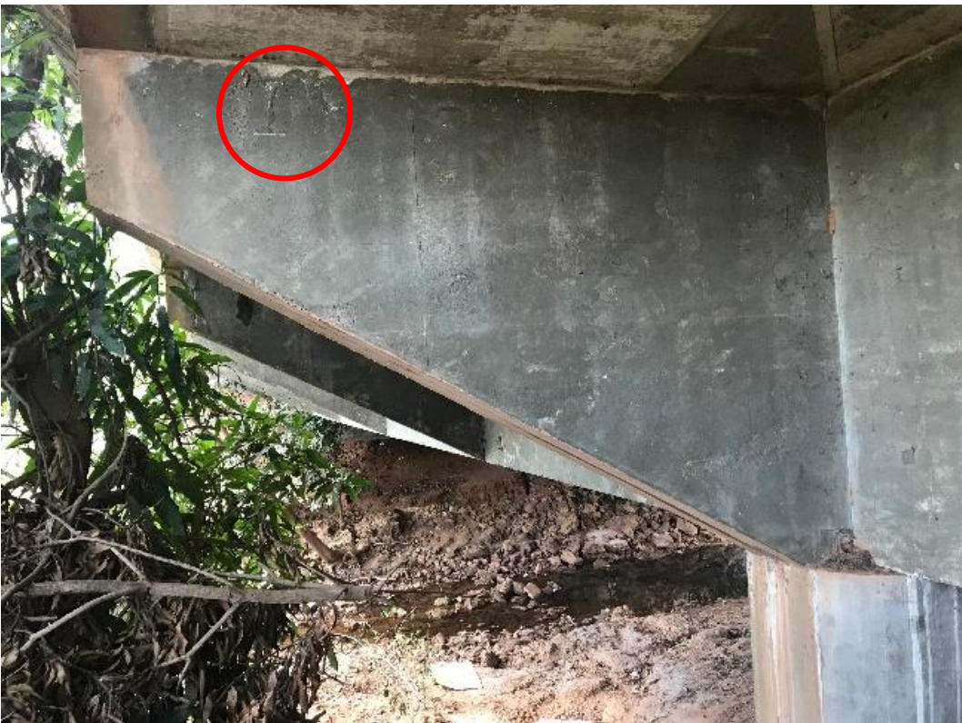
Figura 14 – Presença de bolor e eflorescência na Transversina T8.
