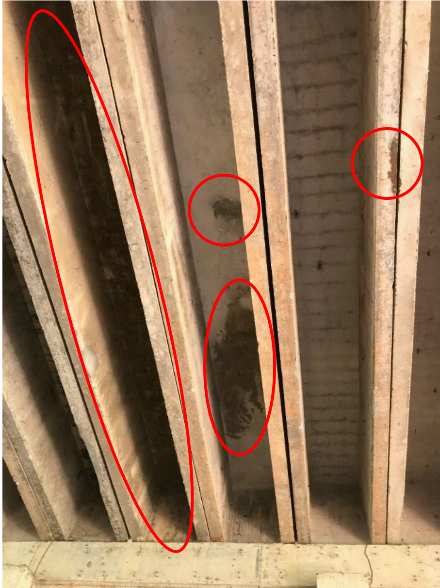
Figura 16 – Presença de bolor no tabuleiro entre as Transversinas T12 a T15.
