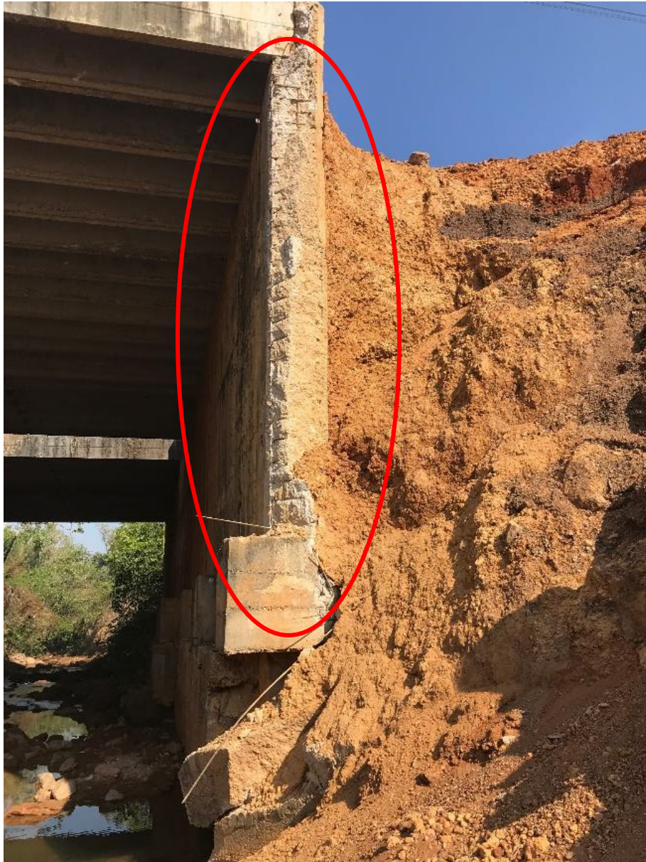
Figura 3 – Colapso da Cabeceira C1.
