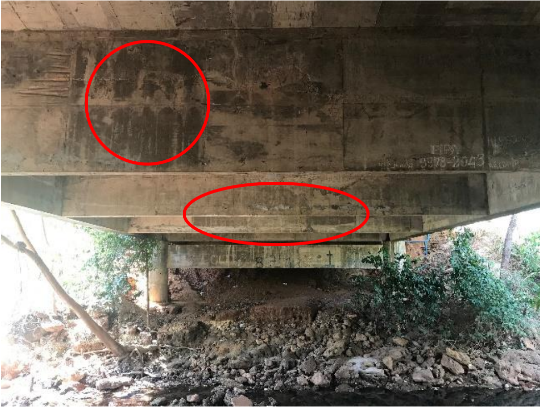
Figura 13 – Presença de bolor nas Transversinas T2 a T5.
