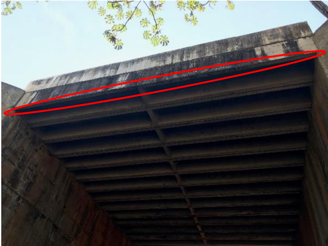
Figura 9 – Presença de bolor na Transversina T38.
