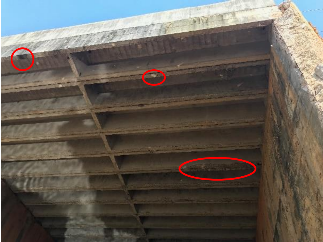
Figura 5 – Presença de bolor, eflorescência e nicho de concretagem no tabuleiro.
