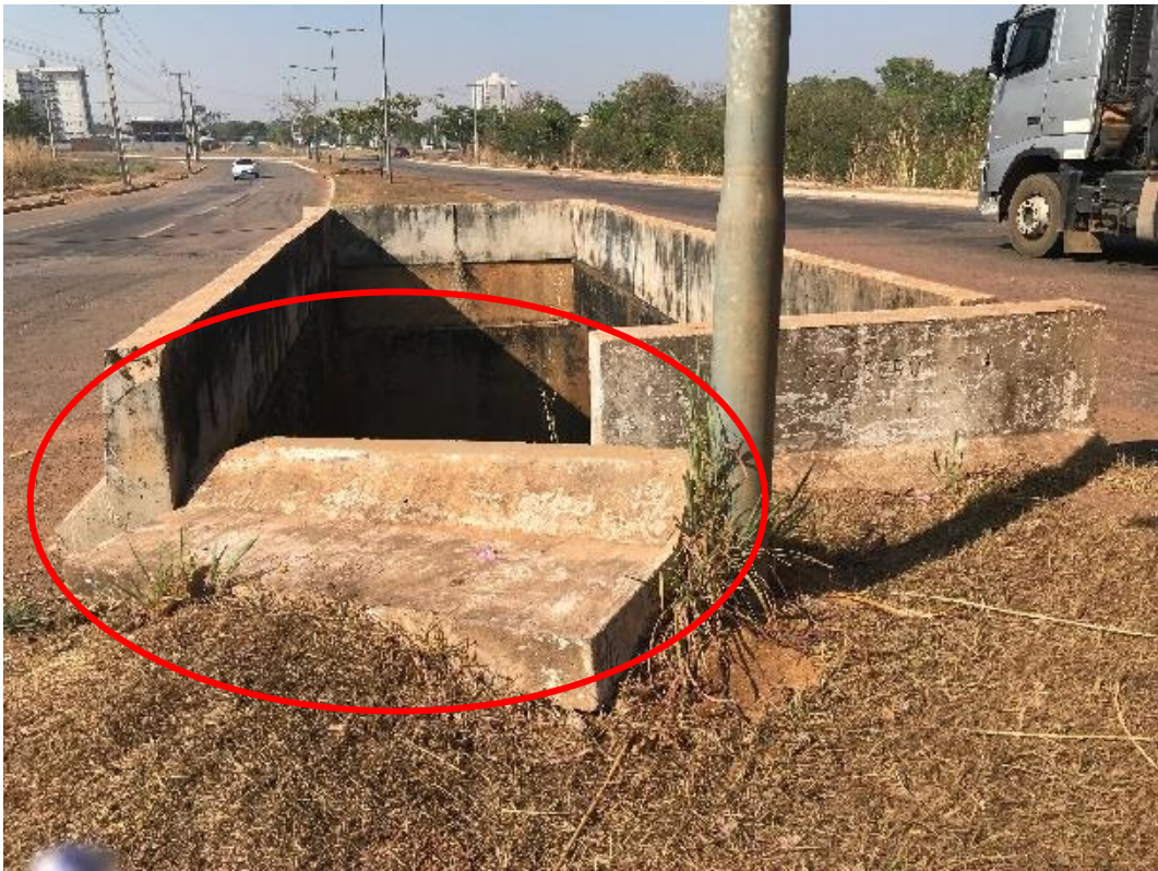
Figura 10 – Colapso do guarda-rodas interno.
