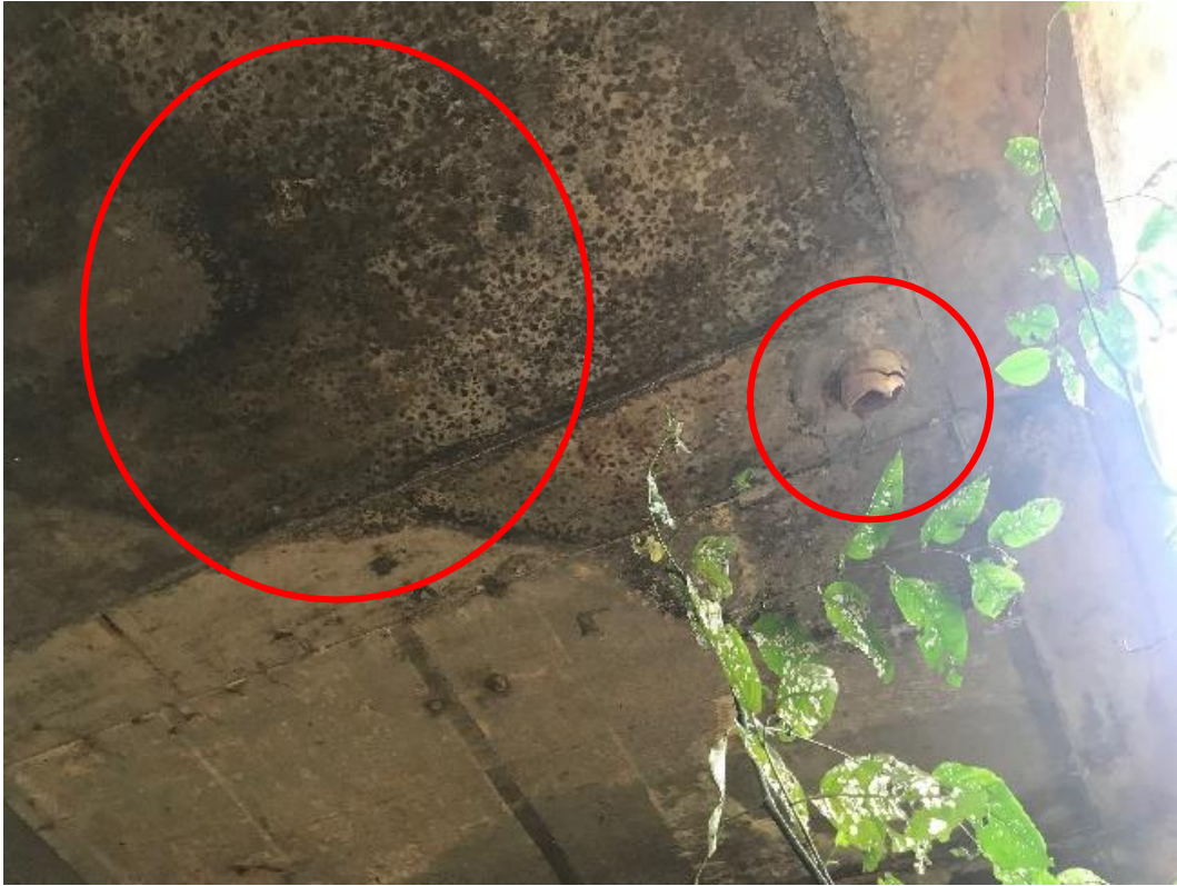
Figura 11 – Presença de bolor no tabuleiro e falha no sistema de drenagem.
