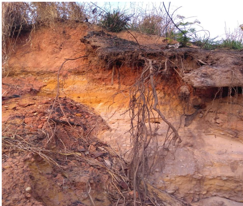
Figura 28: Perfil do talude da voçoroca com altura de 2,80m.
