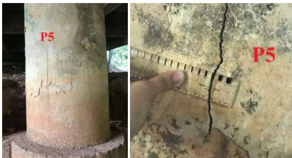
Figura 30 - Análise de rachaduras no Pilar 5, Ponte II.
