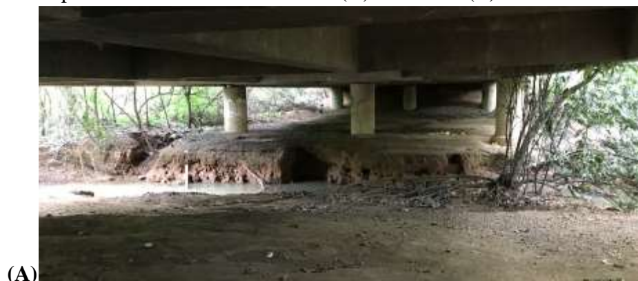
Figura 28 - Erosão presente nos taludes da Ponte I (A) e Ponte II (B).
