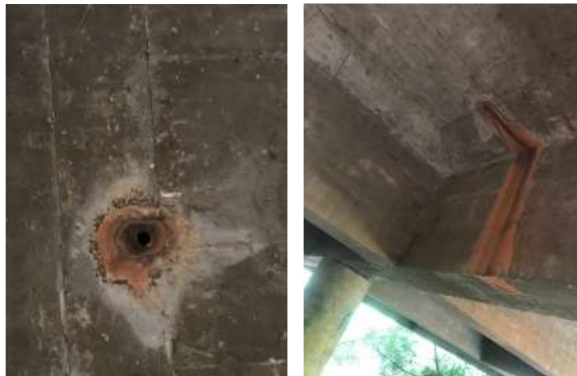
Figura 27 - Corrosão dos tubos de drenagem
