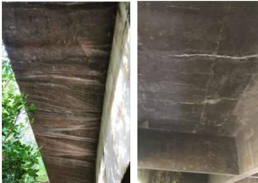
Figura 26 – Eflorescências, Bolores e Manchas de Umidade nos tabuleiros.
