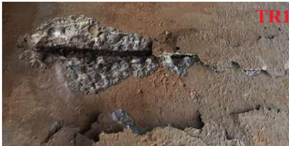
Figura 25 - Corrosão das Armaduras e destacamento do concreto na TR1, Ponte I.
