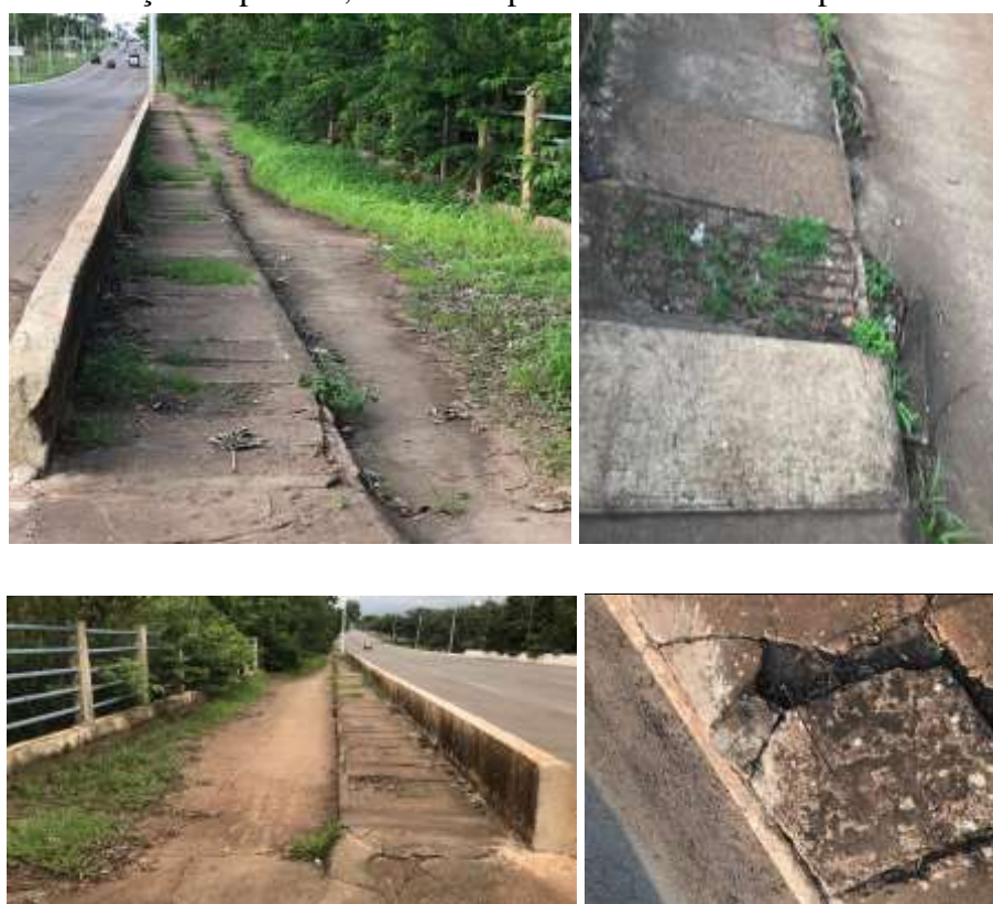
Figura 29 - Deterioração de passeio, danos nas placas e armaduras expostas das Pontes I e II.
