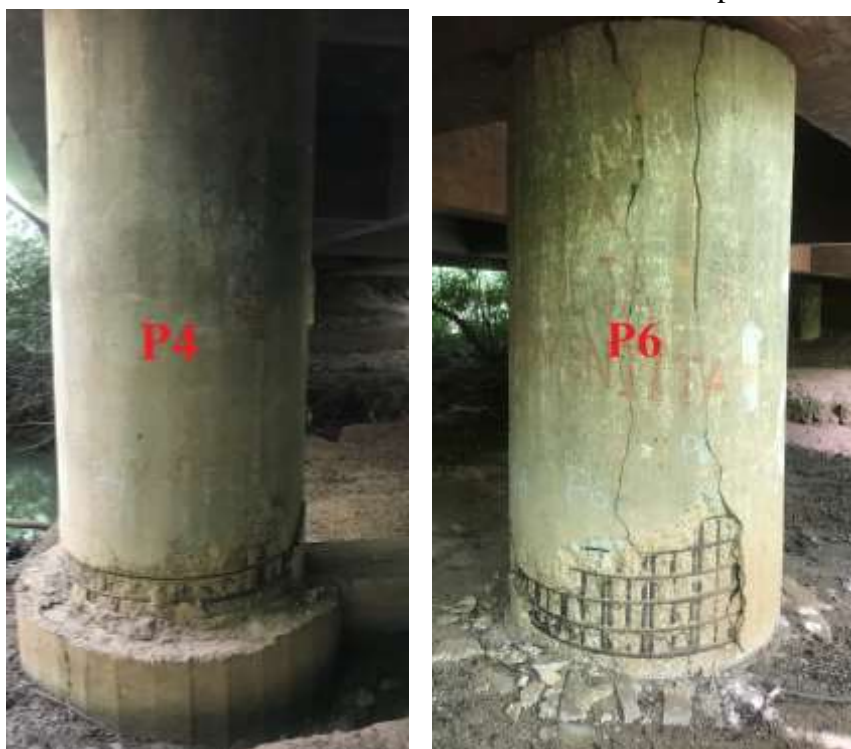
Figura 24 – Corrosão das armaduras e destacamento do concreto nos pilares
