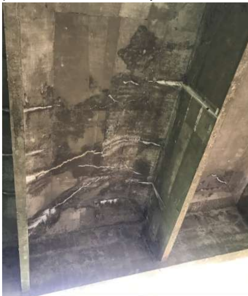
Figura 39 – Presença de eflorescência nos tabuleiros das pontes.
