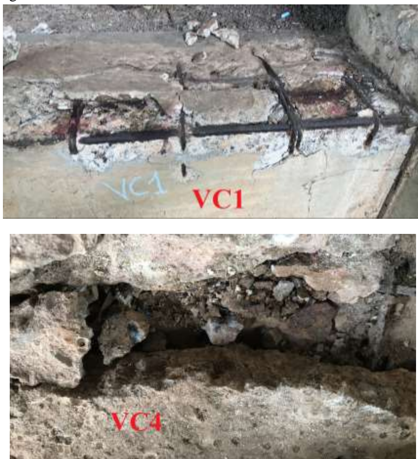
Figura 41 – Vigas de cinta carbonatadas.
