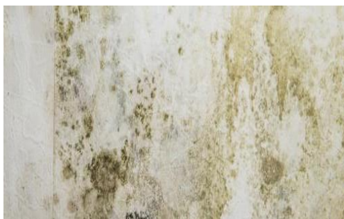
Figura 13 - Formação de bolor no revestimento sob efeito da umidade.
