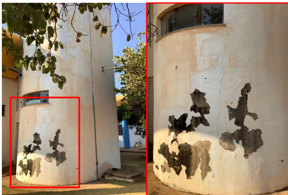
Figura 19 – Anomalias identificadas em revestimento de pintura externo.
