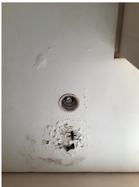
Figura 20 - Anomalias identificadas em forro de gesso.
