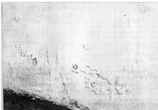
Figura 12 - Pulverulência e desagregação nos pontos empolados, sob efeito da umidade do solo no revestimento e pintura.
