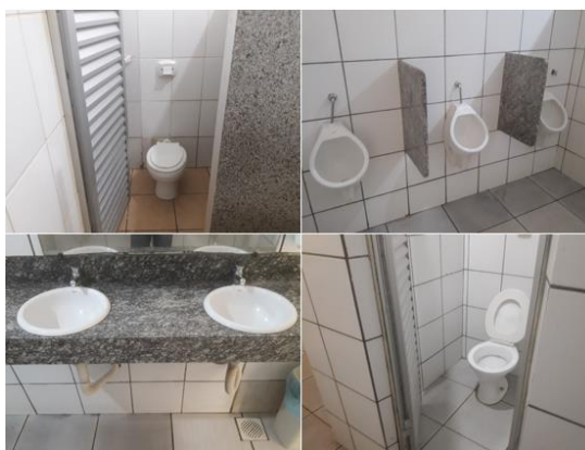
Figura 13– Instalações hidros sanitárias.
