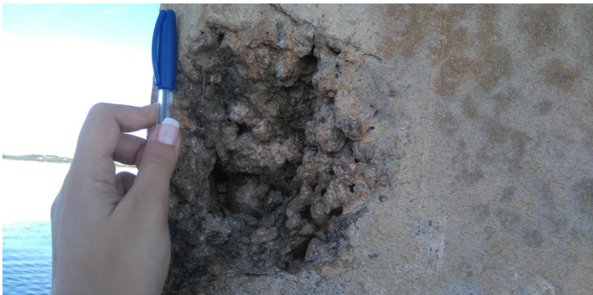
Figura 22 – Ninho de concretagem com exposição da armadura no Pilar 5-B
