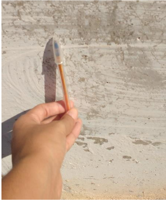
Figura 10 – Fissuras mapeadas presentes em toda a extensão das barreiras New Jersey
