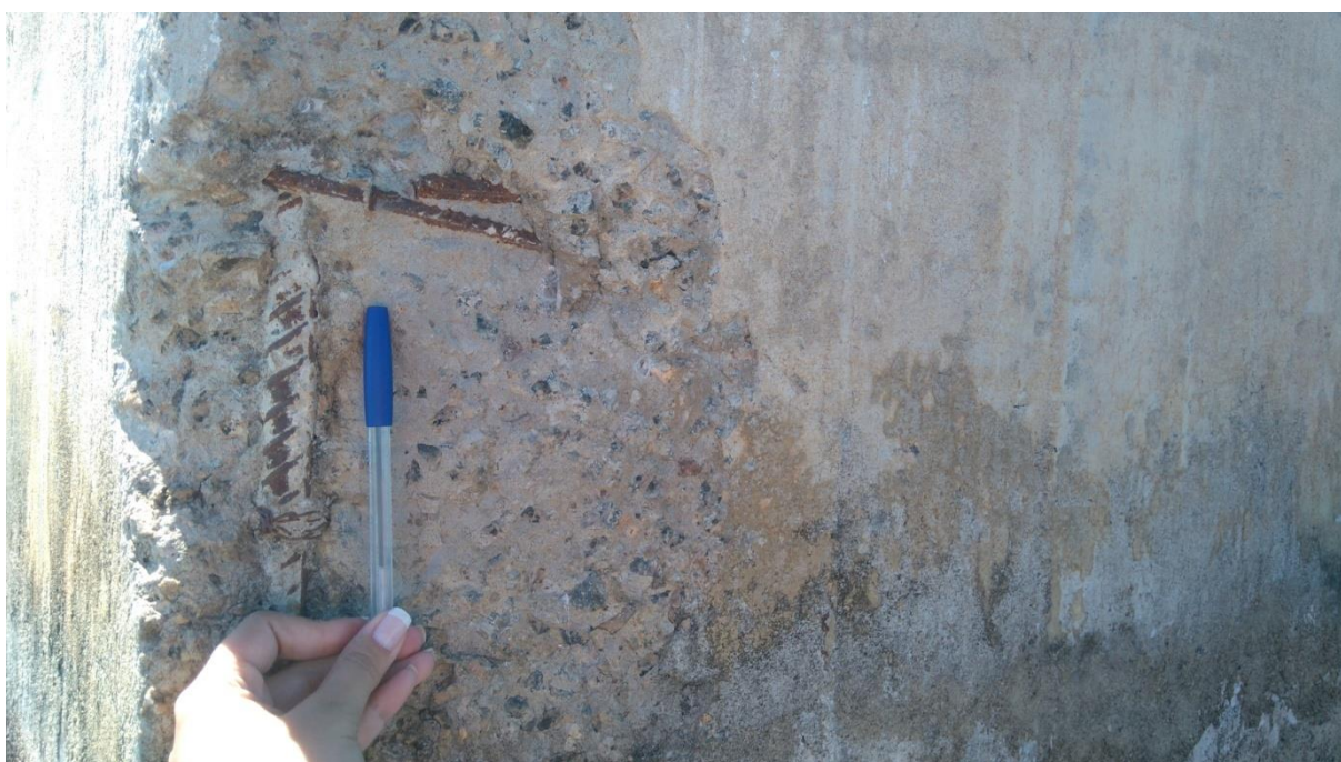
Figura 21 – Desplacamento com exposição de armadura no pilar 13-B.
