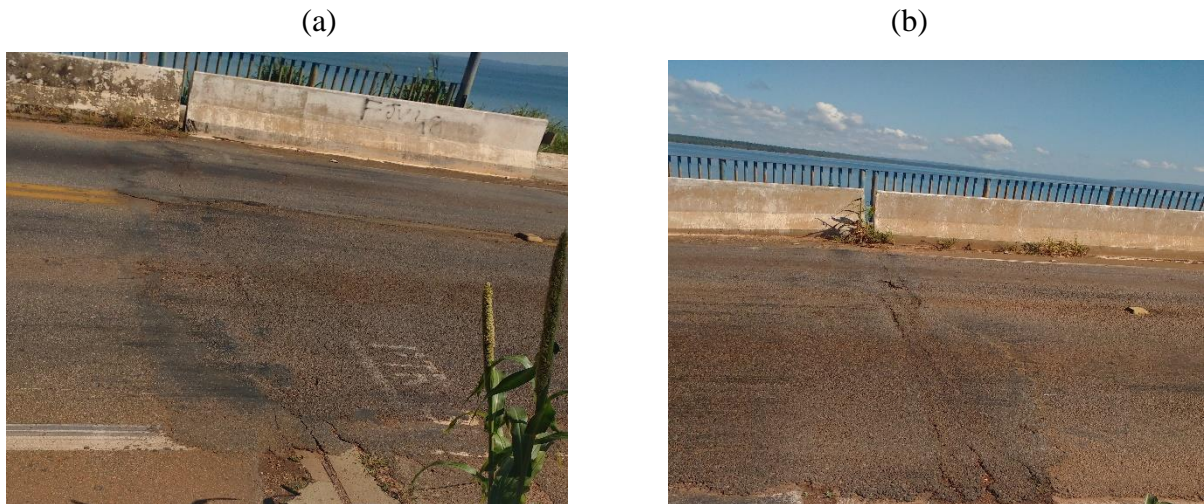
Figura 14 – Juntas de dilatação cobertas por material de revestimento da pista de rolamento.
