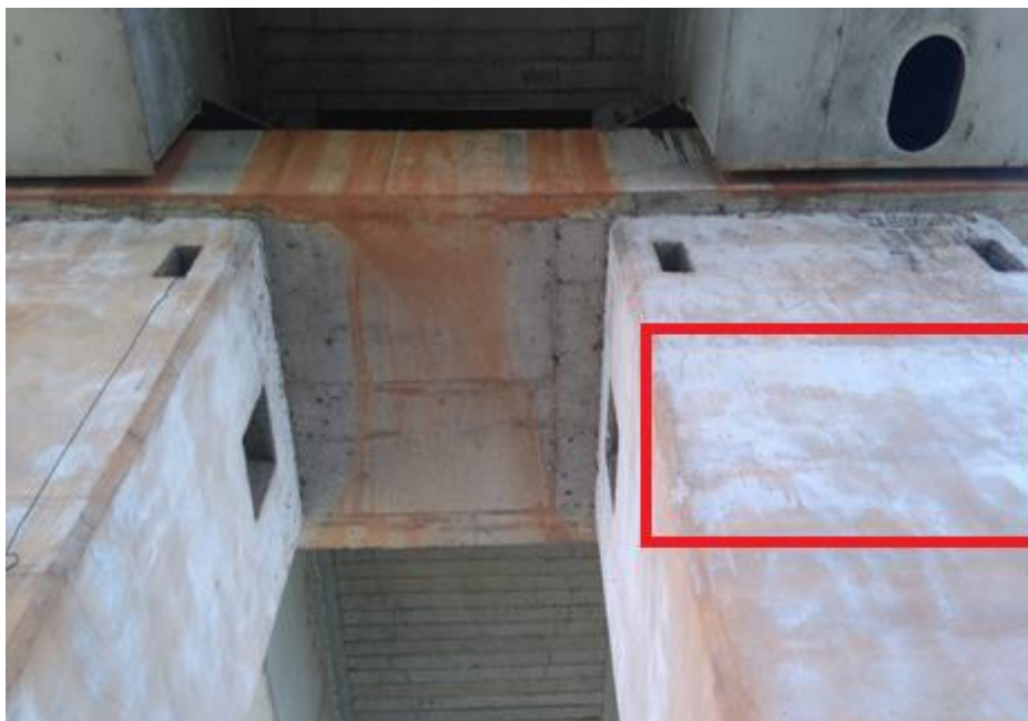
Figura 18 – Início das manifestações de eflorescência (manchas esbranquiçadas)
