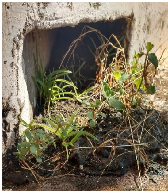
Figura 12 – Vegetação interrompendo a passagem de agua pluvial.
