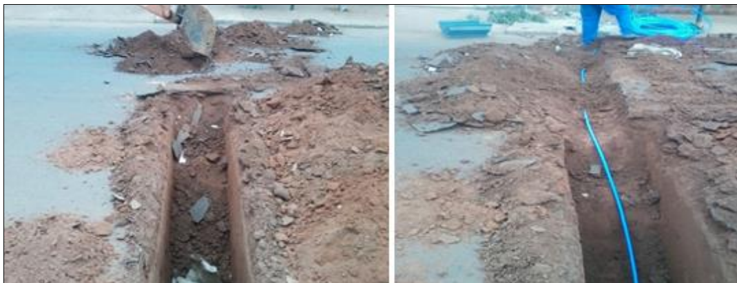
Figura 15 - Execução de ramal de ligação pelo método destrutivo. Fonte: Adaptado de Parente e Silva (2016).
