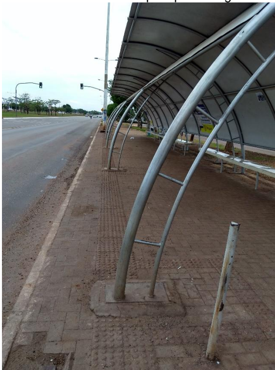
Figura 40: Piso tátil interrompido pelo abrigo de ônibus
