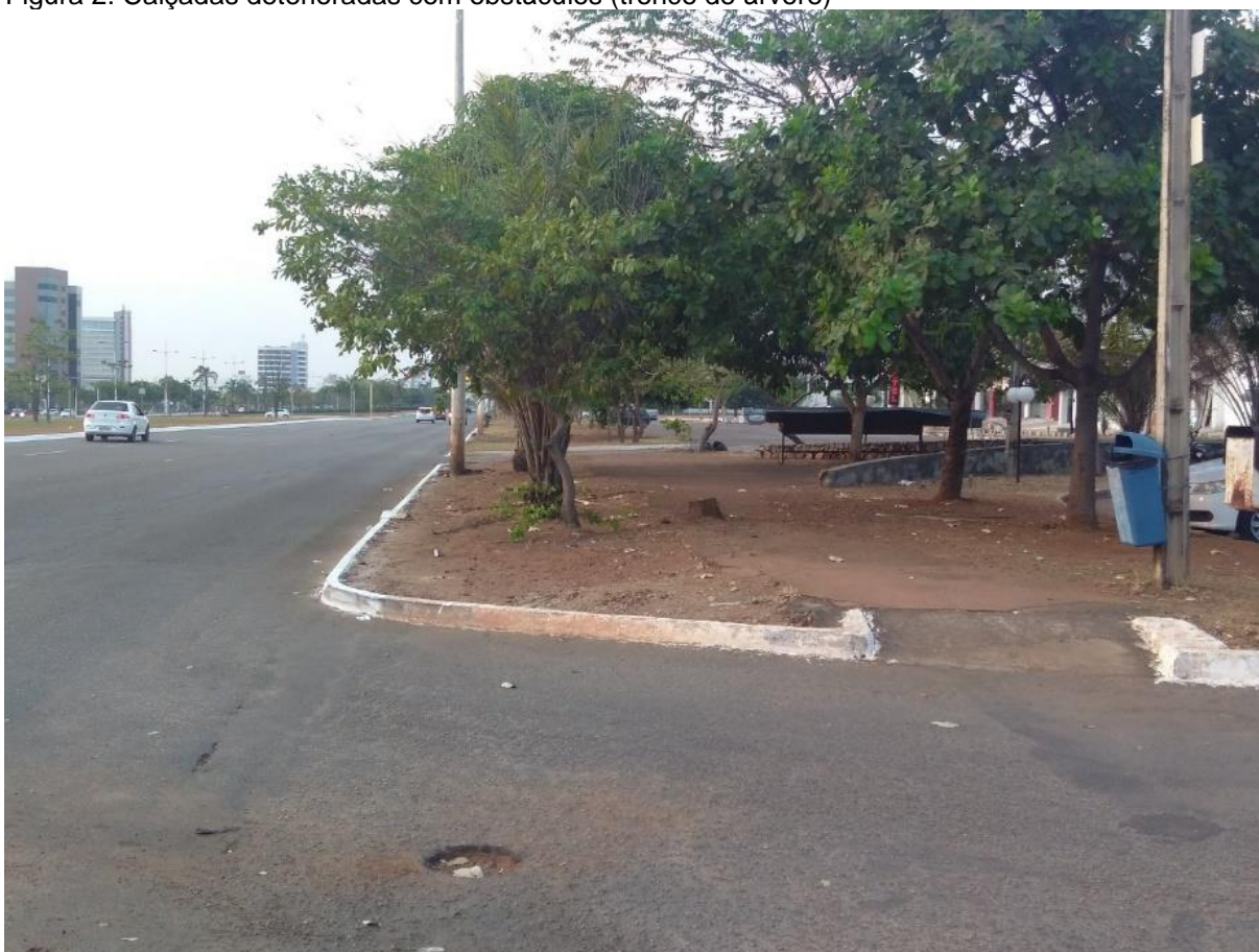
Figura 2: Calçadas deterioradas com obstáculos (tronco de árvore)
