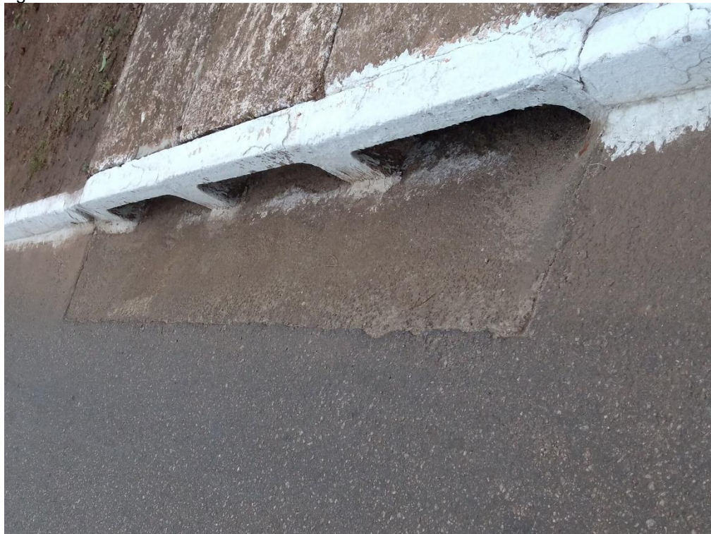
Figura 36: Boca de Lobo de Guia
