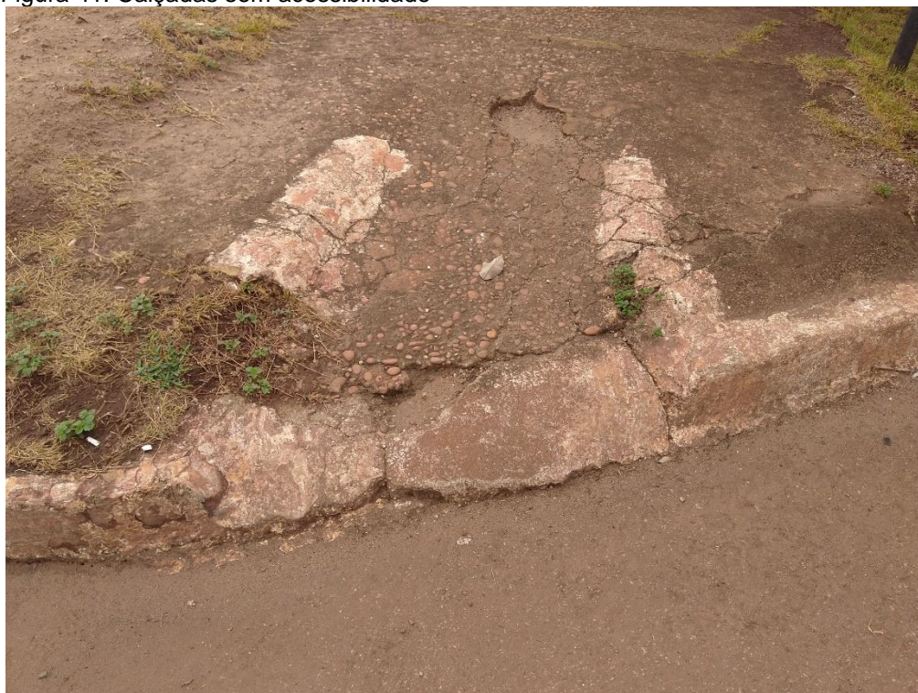
Figura 41: Calçadas sem acessibilidade
