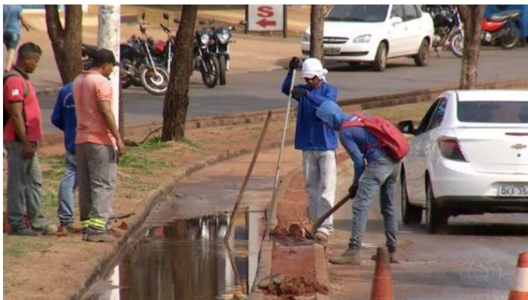
Figura 31: Falta de planejamento de drenagem na avenida
