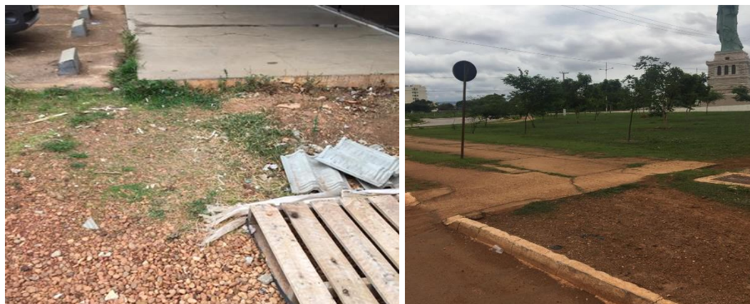
Figura 51: Descontinuidade das calçadas
