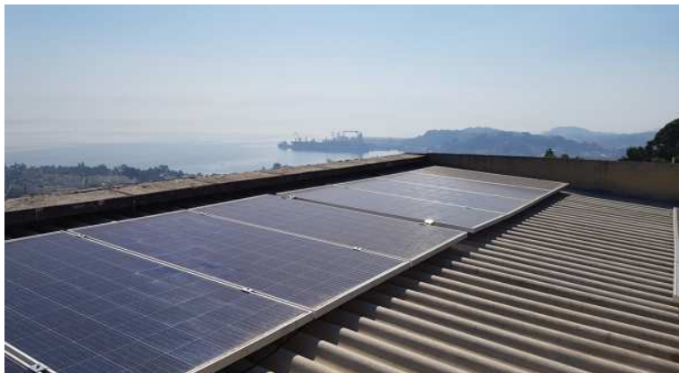
Figura 20 - Sistemas de placas fotovoltaicas.
