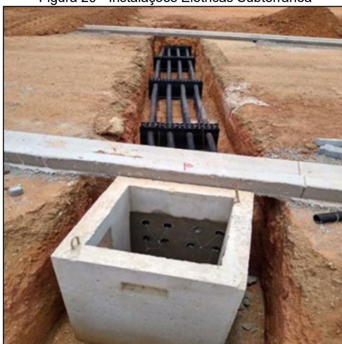
Figura 20 - Instalações Elétricas Subterrânea
