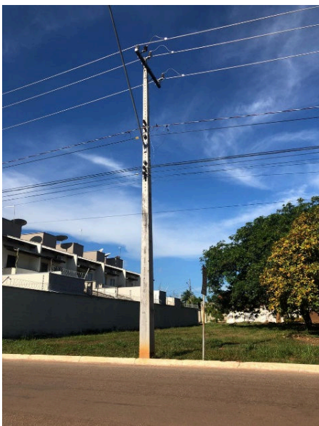
Figura 24: Poste de iluminação
