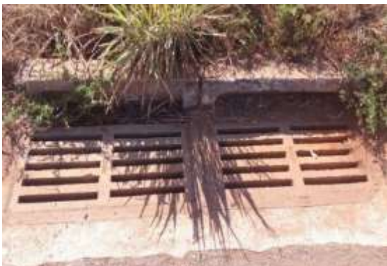
Figura 7. Boca de lobo, bueiro.
