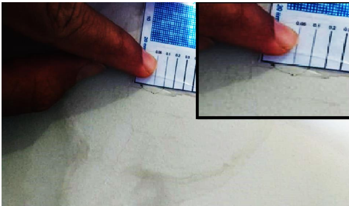
Imagem 33 – Delimitação abertura fissuras Térmicas
