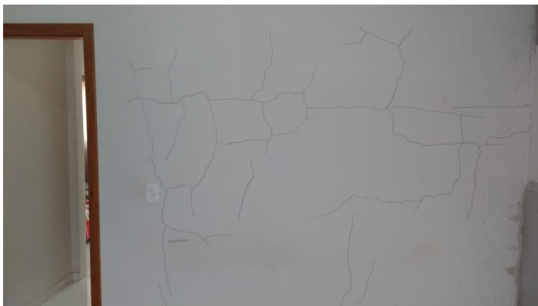
Imagem 28 – Delimitação fissuras mapeadas.
