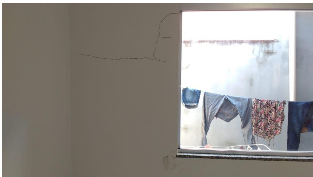
Imagem 34 – Delimitação fissuras térmicas
