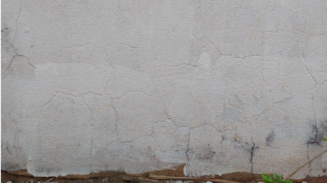
Imagem 4 – Parede externa com fissuras mapeadas.
