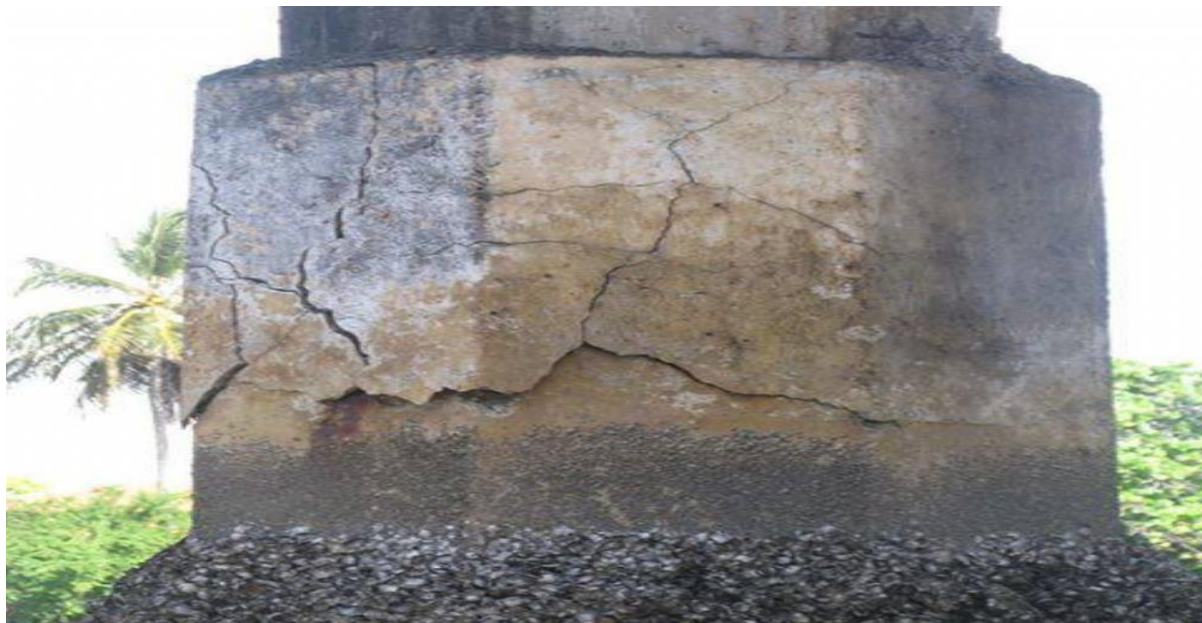
Figura 10 - Imagem de fissura em um pilar
