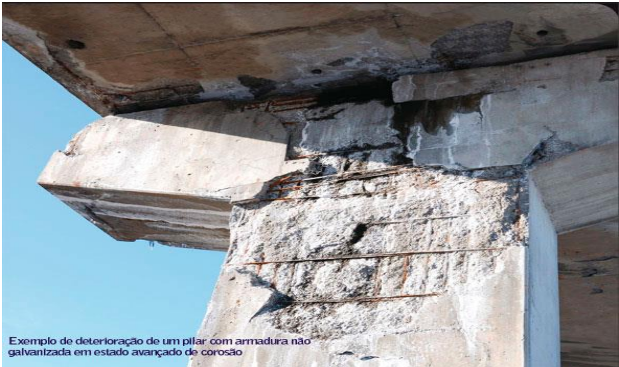
Figura 12 - Corrosão em um pilar
