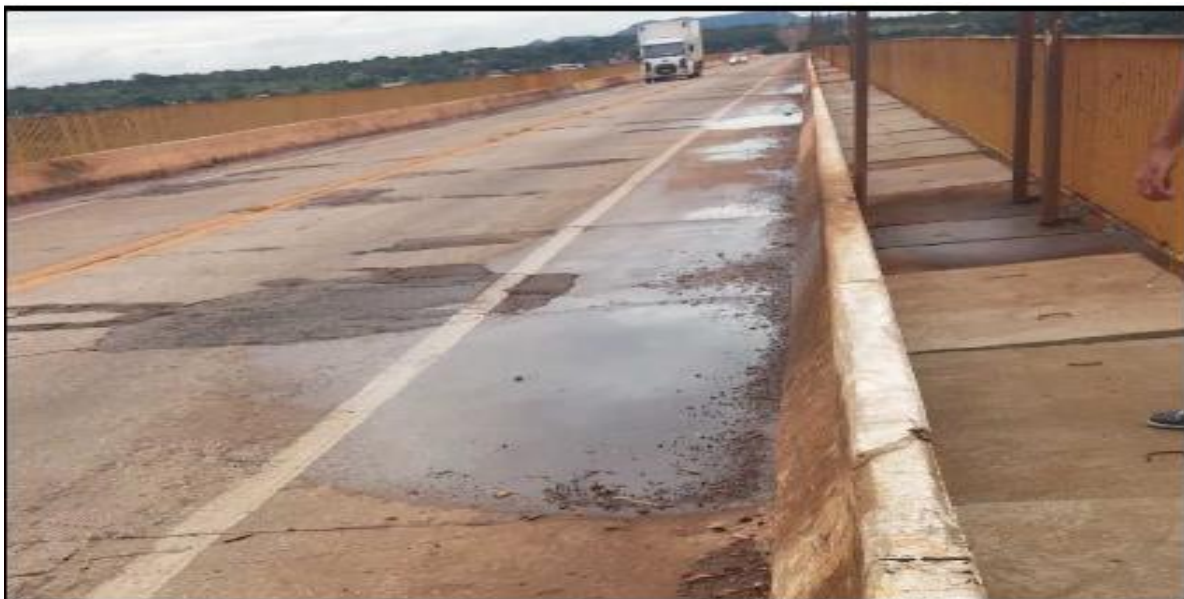
Figura 11 - Falha do Sistema de Drenagem – Ponte Sobre o Rio Tocantins
