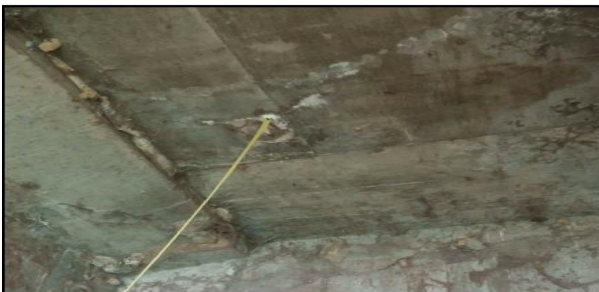
Figura 14 - Eflorescência na parte inferior dos tabuleiros
