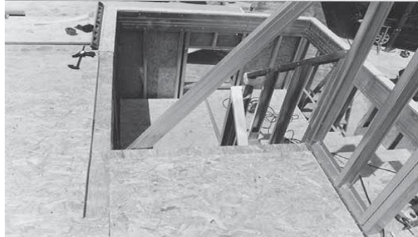
Figura 13. Placas de OSB utilizadas para laje seca
