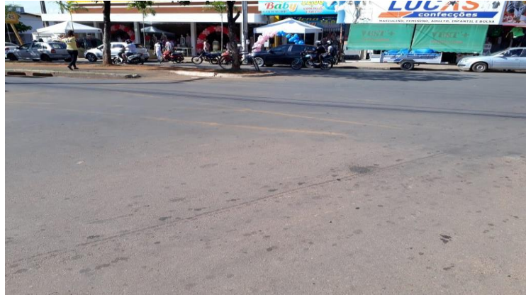
Figura 30- Trecho localizado no cruzamento da Av. Teotônio segurado com sinalização apagada.
