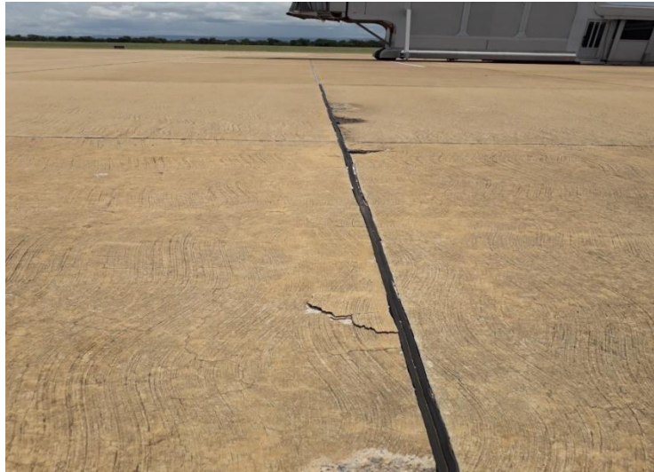
Figura 21 - Desplacamento do concreto.
