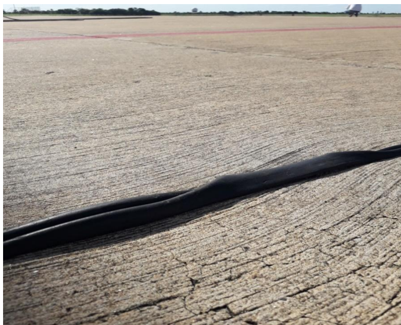
Figura 19 - Expansão do concreto expulsando material de impermeabilização
