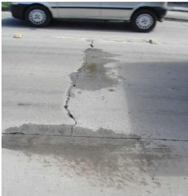
Figura 7 – Fissuração de retração térmica.
