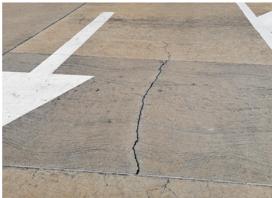
Figura 23 - Trincas da RAA com as maiores espessuras.
