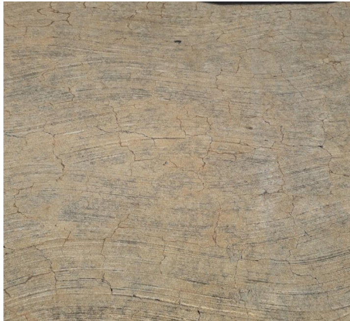
Figura 17 - Fissuras mapeadas no pavimento de concreto.
