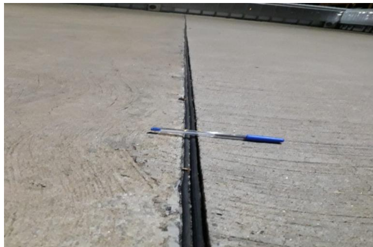
Figura 13 - Desnível de placas.
