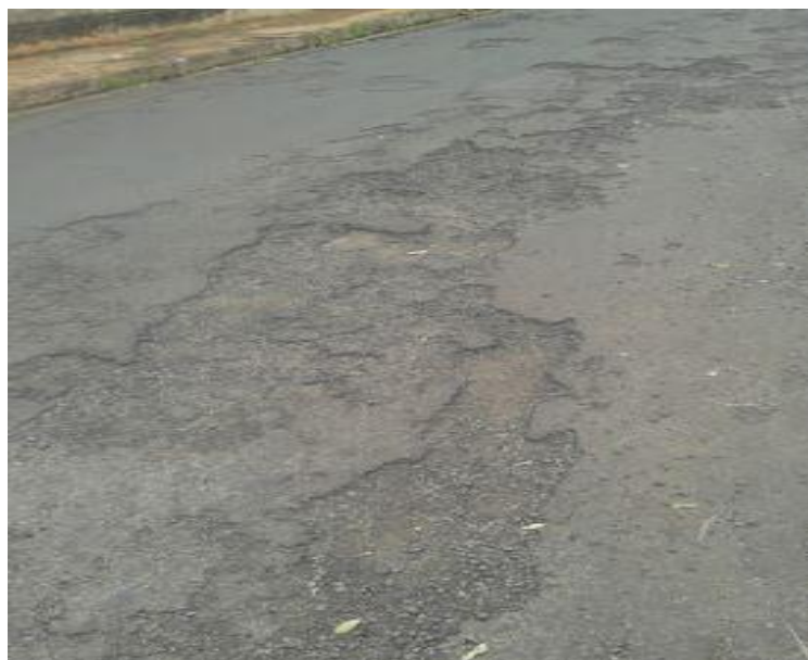
Figura 5 - Desgaste superficial no pavimento.
