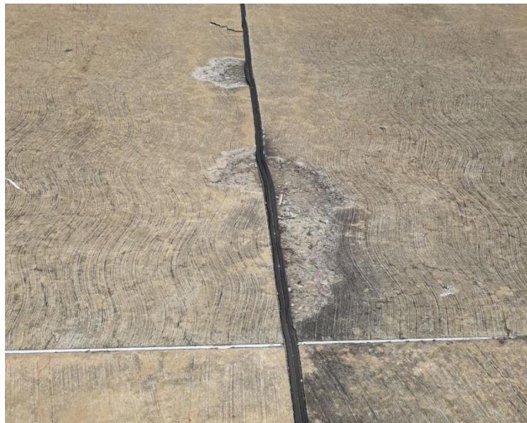
Figura 22 - Buracos no pavimento de concreto.
