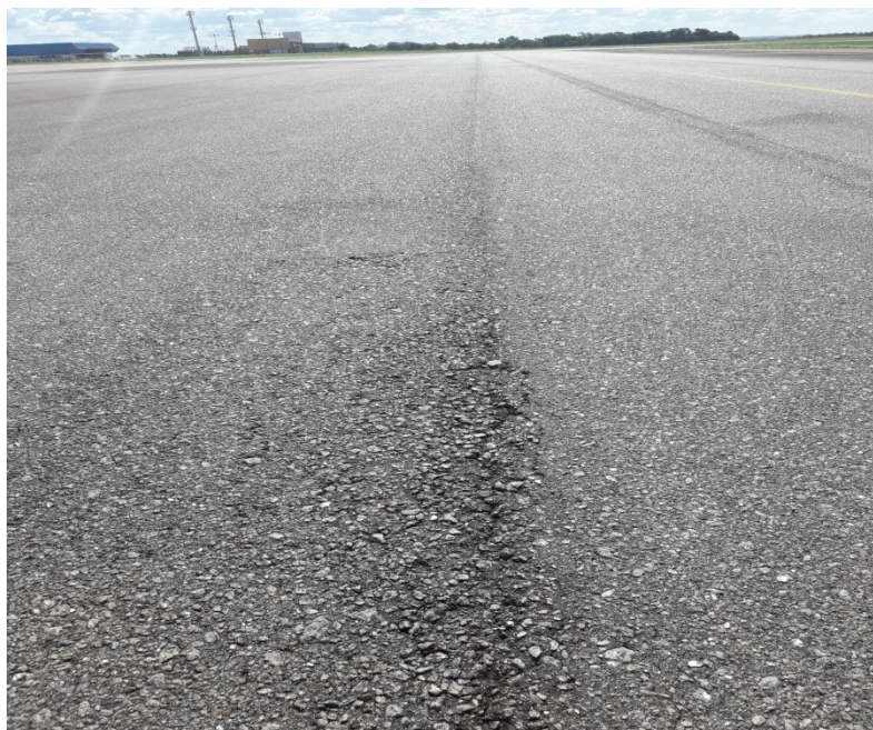
Figura 28 - Desgaste superficial no pavimento flexível.
