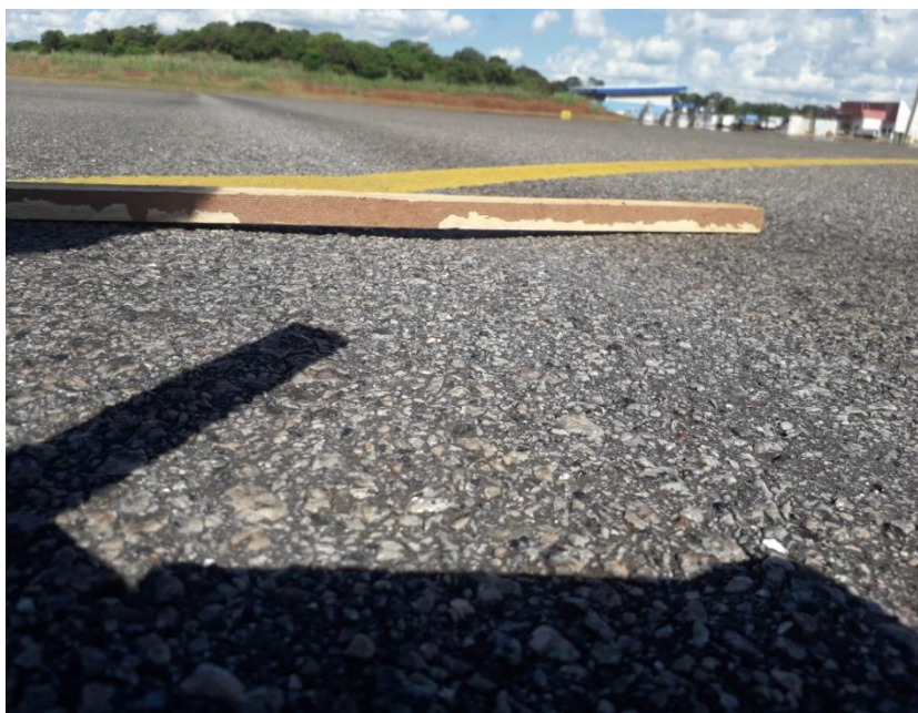
Figura 27 - Afundamento no pavimento flexível.
