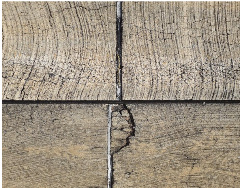
Figura 18 - Trincas mapeadas no Pavimento de concreto.
