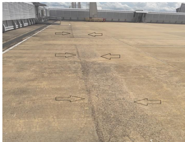
Figura 15 - Desgaste superficial pavimento rígido.
