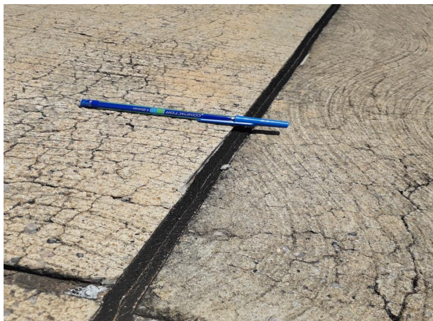
Figura 24 - Desnível das placas.
