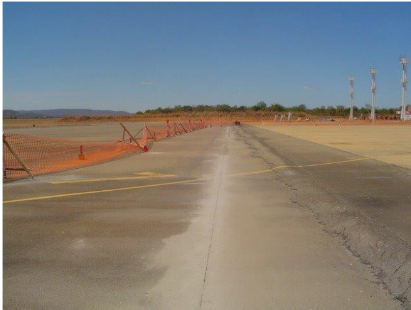
Figura 20 - Lombada formada no Pavimento de concreto.
