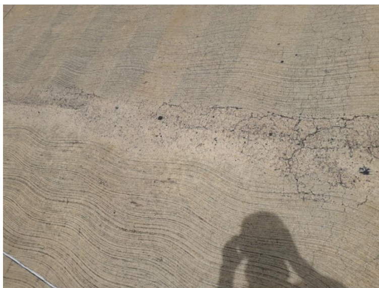
Figura 16 - Desgaste superficial pavimento de concreto.
