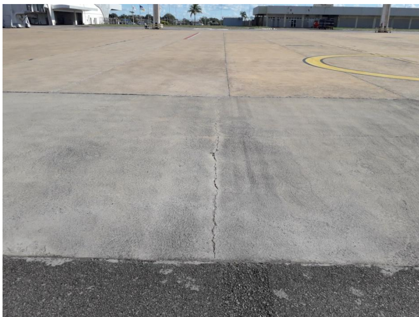
Figura 25 - Trinca geométrica em decorrência da retração térmica.
