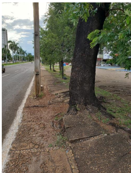
Figura 11 – Calçadas danificadas, as margens avenida JK.
