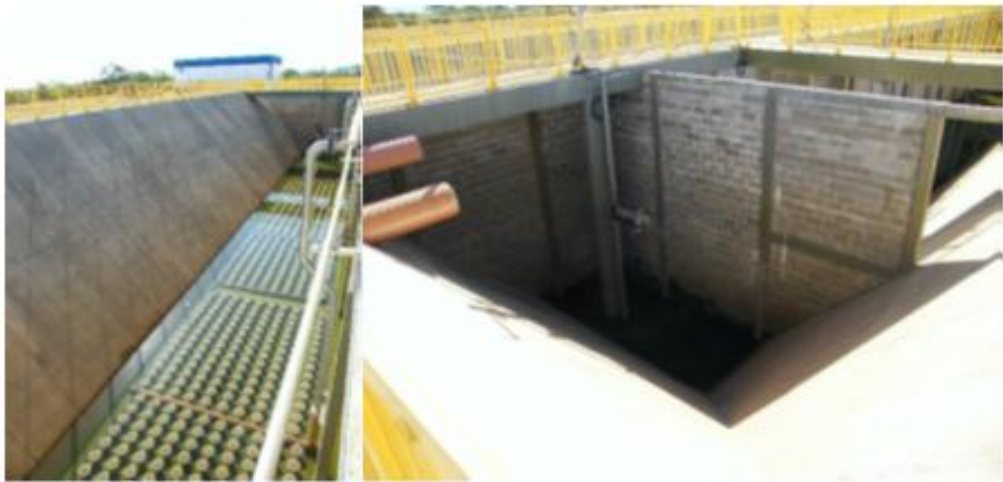
Figura 19 - Vista interna do Tanque de Aeração ETE Norte
