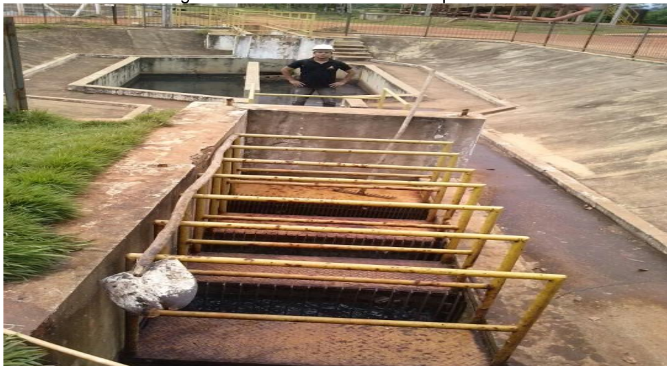
Figura 10 - Grades do tratamento primário
