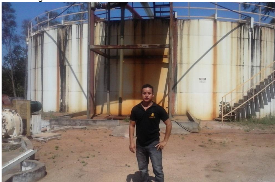
Figura 29 - Reator anaeróbio de fluxo ascendente - UASB
