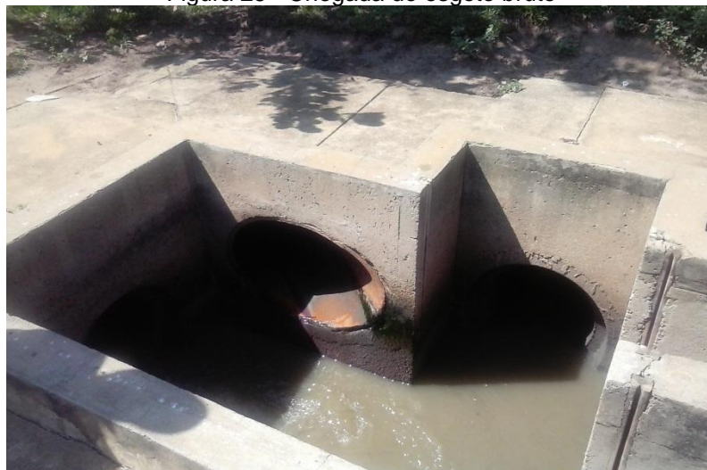
Figura 25 - Chegada do esgoto bruto
