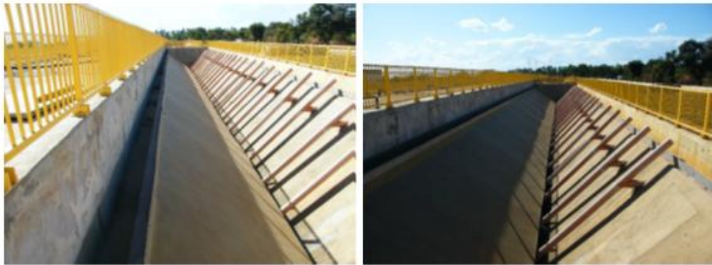
Figura 18 - Vista interna dos reatores UASB ETE Norte
