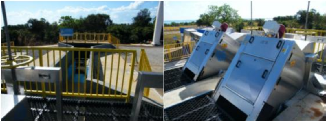
Figura 17 - Peneira mecanizada ETE Norte
