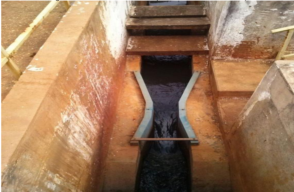
Figura 12 - Medidor de vazão (Calha Parshall - entrada)
