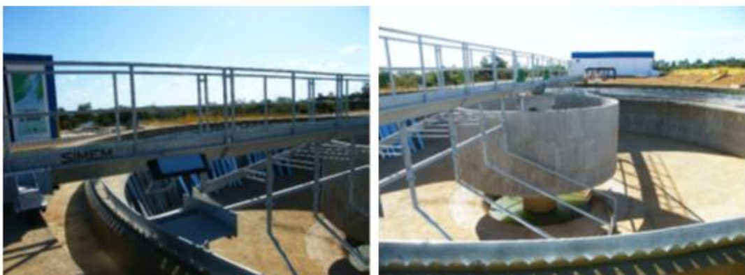
Figura 20 - Vista do Decantador ETE Norte
