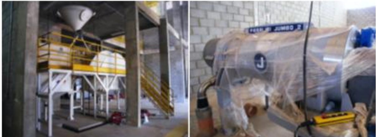
Figura 21 - Sistema de desidratação do lodo ETE Norte
