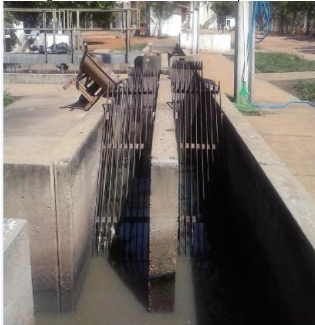
Figura 26 - Grades do tratamento primário
