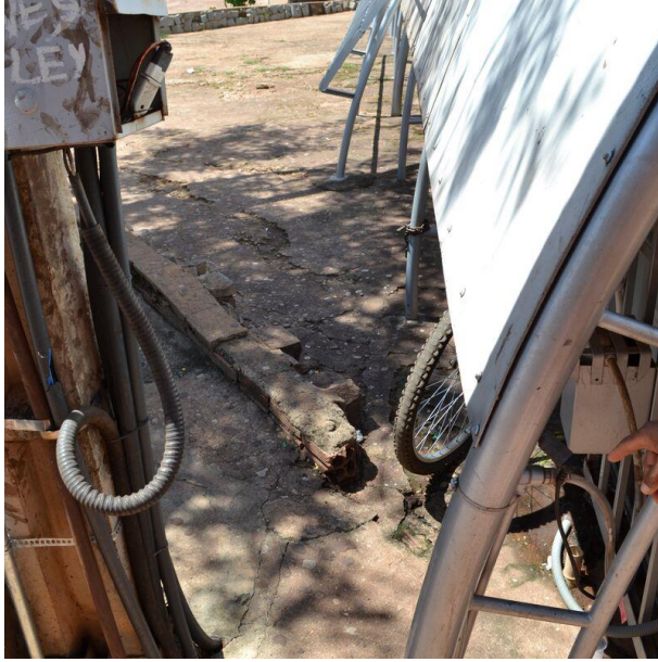
Figura 26 - Quadro de força e Bebedouro
