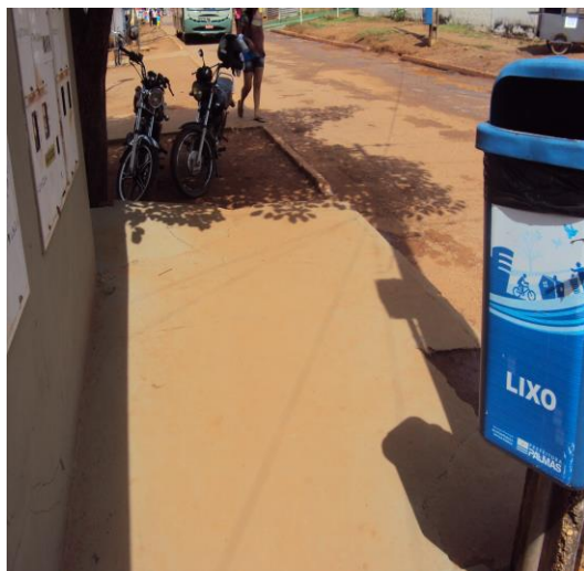
Figura 75 - Descontinuidade e desgates nas calçadas da Estação Javaé
