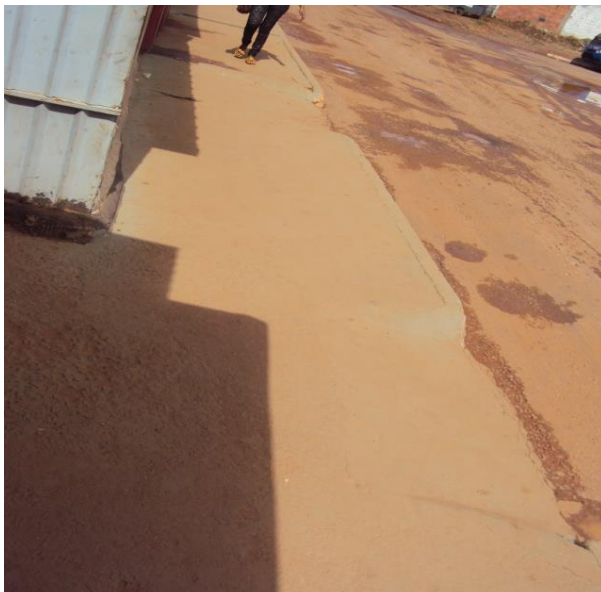
Figura 71 - Calçadas desnivelada na Estação Javaé
