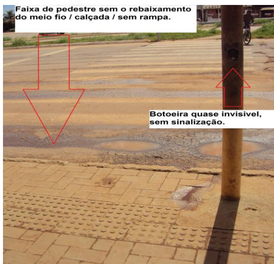
Figura 82 - Faixa de pedestres e boteeira sem manutenção
