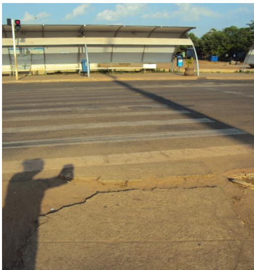
Figura 81 - Faixa de pedestres e boteeira sem manutenção
