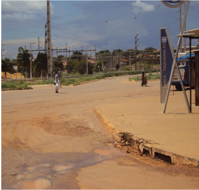
Figura 65 - Vista da Rodovia TO 050 com travessia de pedestre fora da faixa
