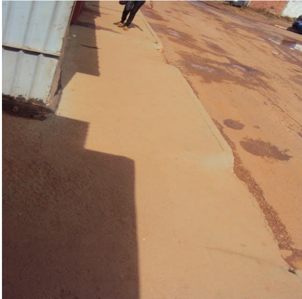
Figura 72 - Calçadas desnivelada na Estação Javaé
