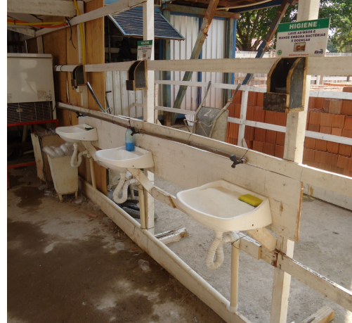
Figura 44- Pias do refeitório
