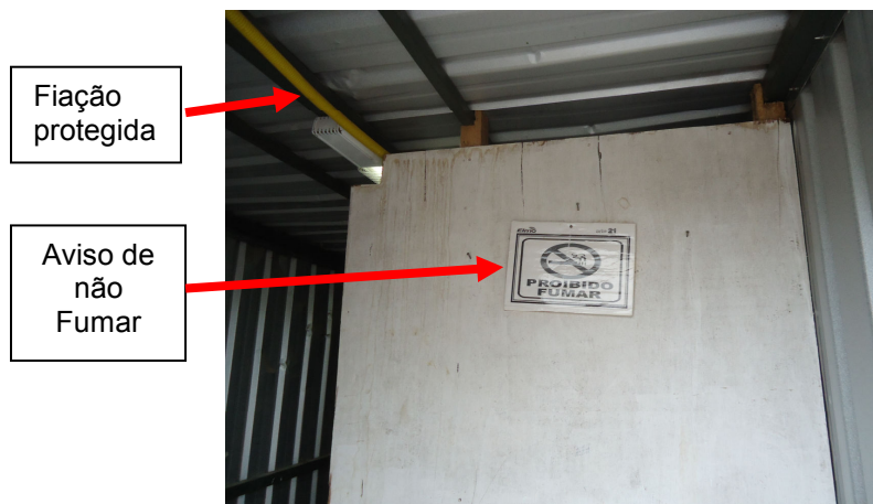
Figura 17 - Parte elétrica e Aviso de Segurança
