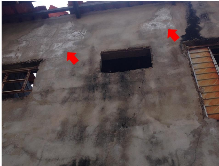
Figura 35 - Eflorescência nas proximidades das do telhado.
