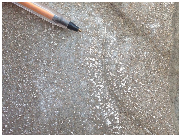
Figura 36 - eflorescência nas paredes das fachadas.
