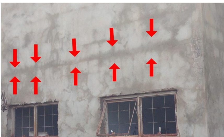
Figura 26 - Fissura horizontal na altura da laje.
