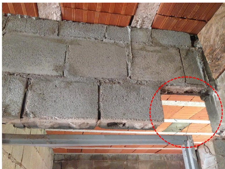
Figura 33 - Destacamento de blocos estruturais de concreto no vão de uma porta de um quarto.
