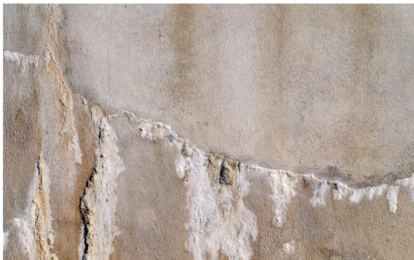
Figura 18 - Formação de depósitos de eflorescências.
