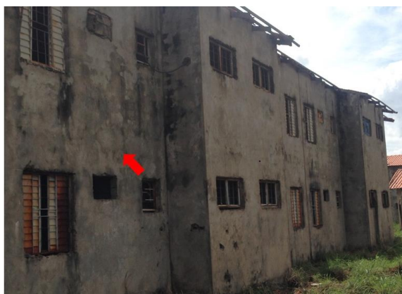
Figura 30 - Manchas de bolor de coloração negra distribuído por grande superfície das paredes das fachadas.
