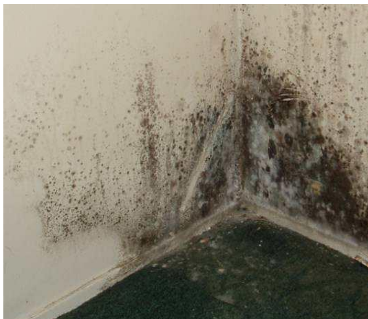
Figura 17 - Bolor em paredes.
