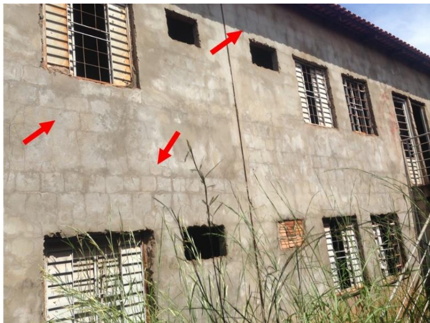
Figura 22 - Fissuras geométricas guiadas pelas juntas de argamassa que unem os blocos de concreto.
