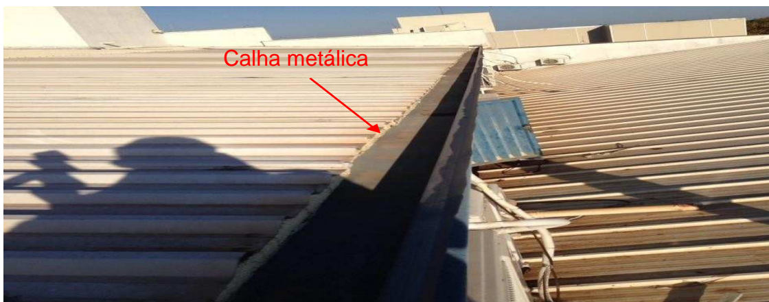
Figura 13 - Identificação de Sistema de Captação Pluvial – Calha Metálica
