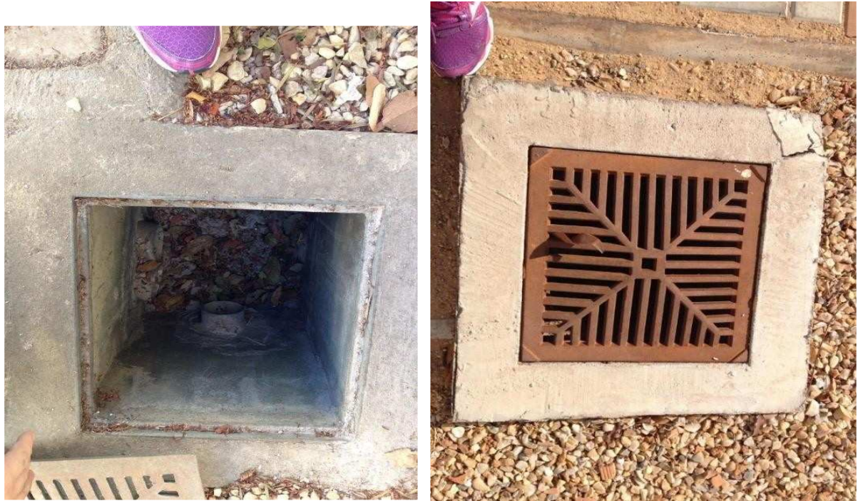
Figura 15 - Identificação de Sistema de Captação Pluvial - Caixa de Passagem Coletora Pluvial
