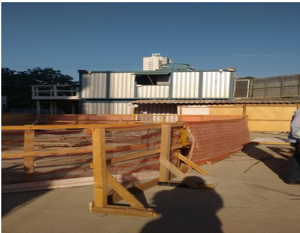
Figura 13. Contêiner Instalações Sanitárias e Vestiário Amostra 6.
