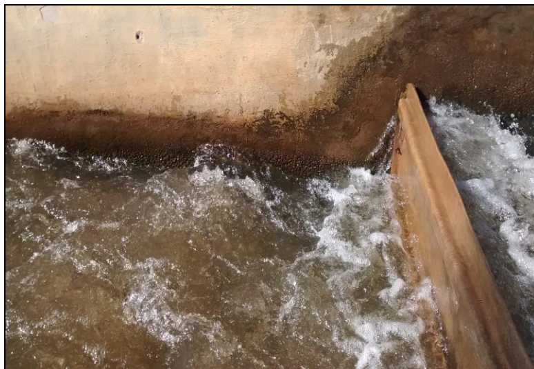
FIGURA 24 - Erosão na parede da câmara de floculação. Fonte: Autoria Própria (2015).
