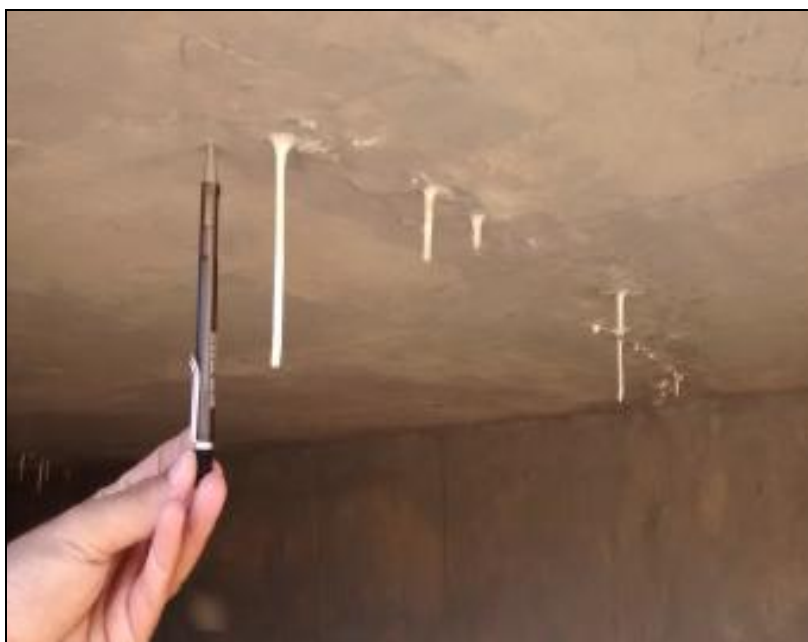
FIGURA 19 - Estalactite formada por lixiviação de sal de hidratação do concreto endurecido em laje de fundo do decantador. Fonte: Autoria Própria (2015).
