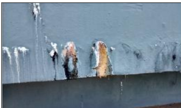
FIGURA 22 - Eflorescências e manchas de bolor em parede da câmara de decantação. Fonte: Autoria Própria (2015).
