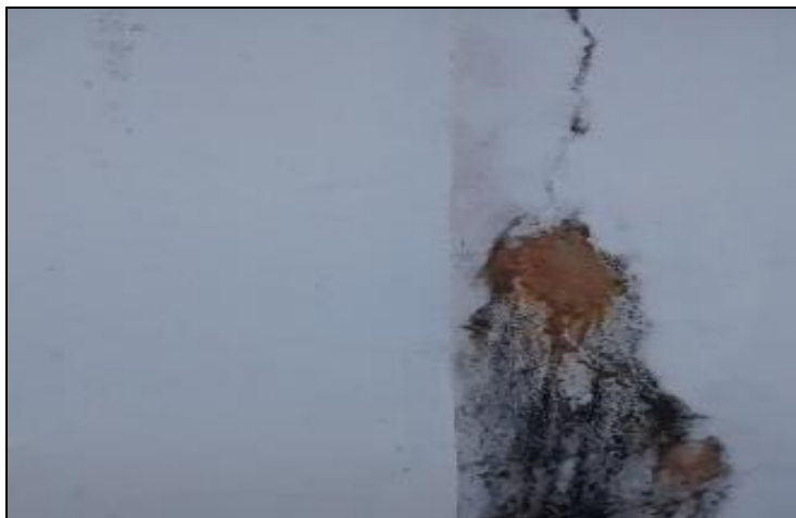
FIGURA 25 - Parede do reservatório com sinais de eflorescências e manchas de bolor. Fonte: Autoria Própria (2015).
