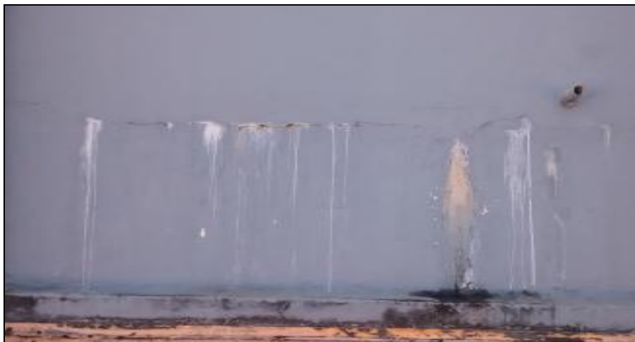
FIGURA 20 - Eflorescência na parede do floculador. Fonte: Autoria Própria (2015).
