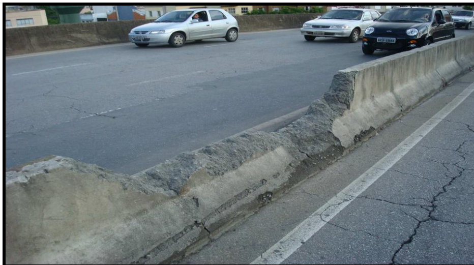
FIGURA 3 - Concreto rompido por batida de veículos em viaduto de Belo Horizonte (MG). Fonte: Santos (2012).
