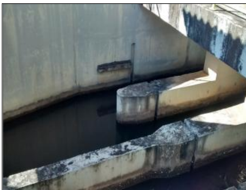
FIGURA 17 - Superfície de concreto do sistema de captação com manchas de mofo e bolor.
