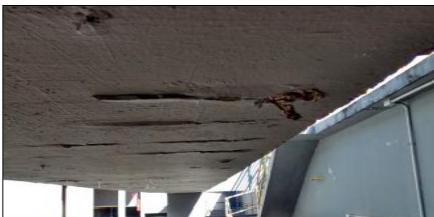
FIGURA 21 - Corrosão de armadura evoluindo para deslocamento de concreto em laje de câmara de floculação.
