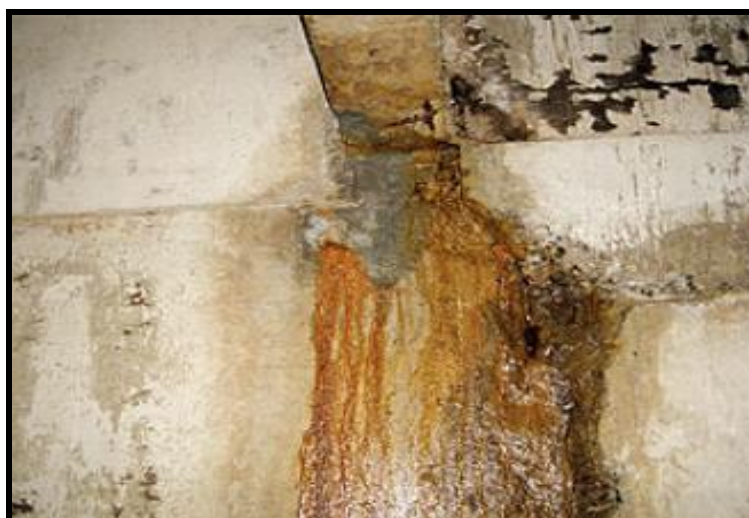
FIGURA 14 - Corrosão de armaduras em subsolo por infiltração de água.
