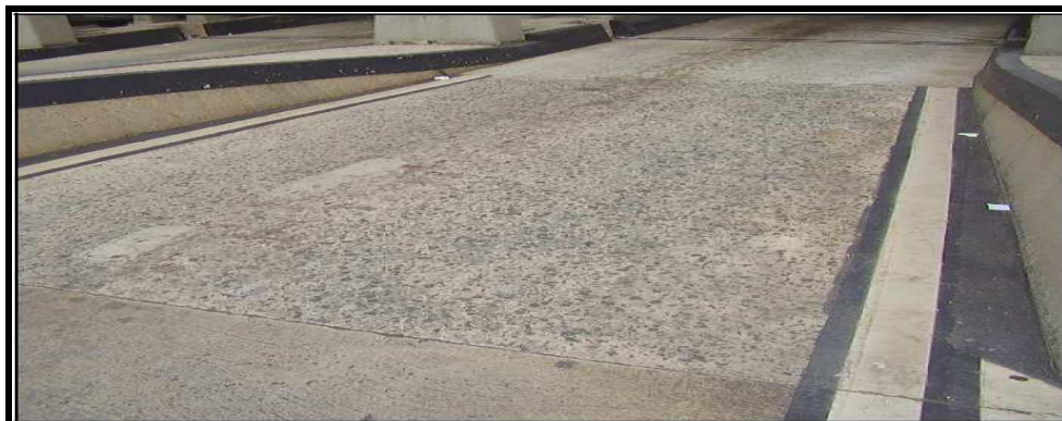
FIGURA 4 - Desgaste superficial por abrasão em pavimento de concreto. Fonte: Aguiar (2006).
