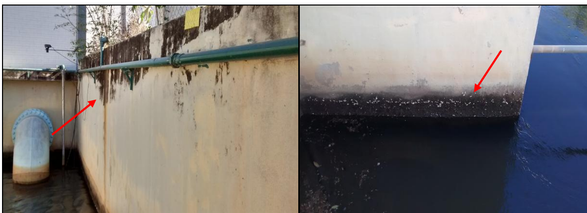
FIGURA 23 - Manchas e bolor localizados no módulo de tratamento flocluladores e decantadores. Fonte: Autoria Própria (2015).
