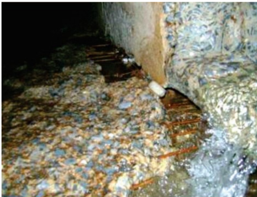
Figura 5 - Desgaste superficial do concreto
