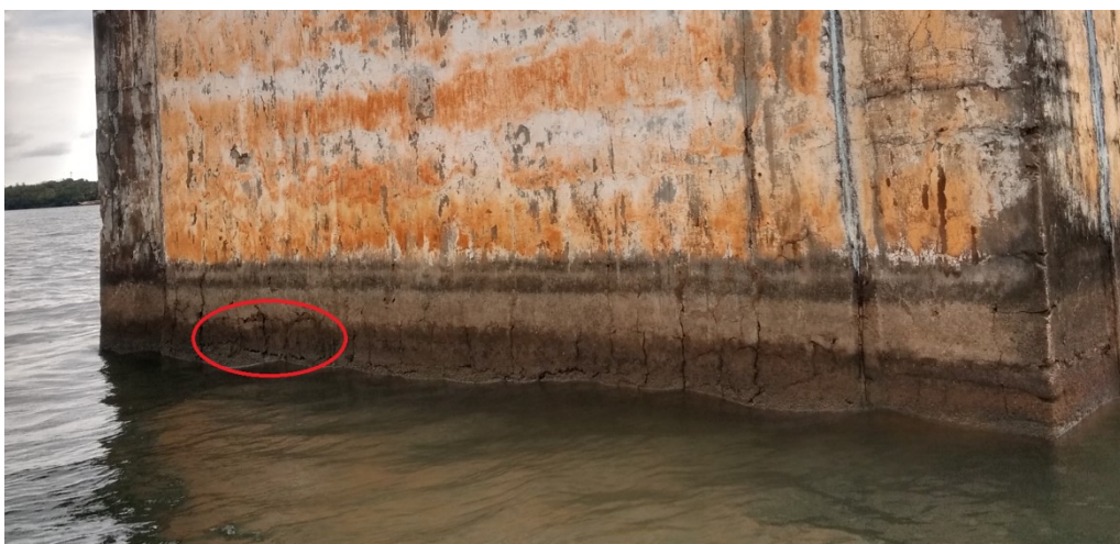
Figura 15 - Fachada montante do pilar P6 em 2020
