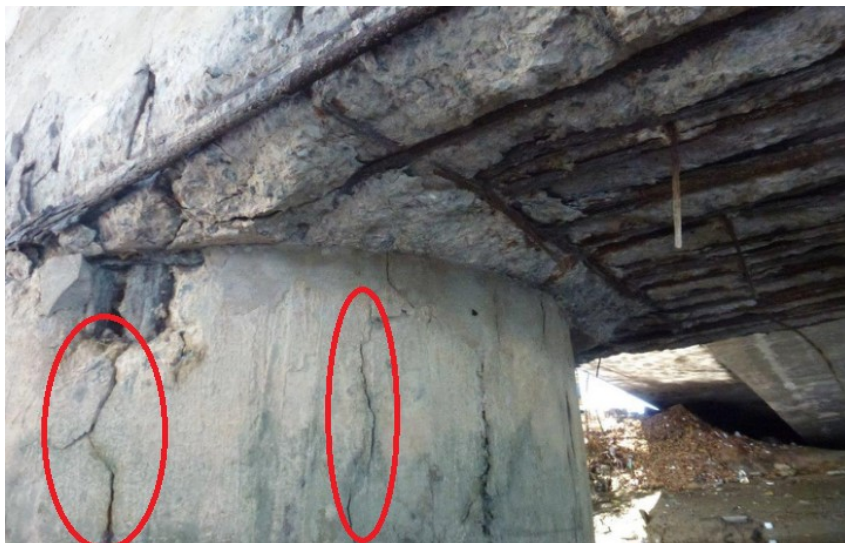
Figura 2 - Fissuras no pilar de uma ponte
