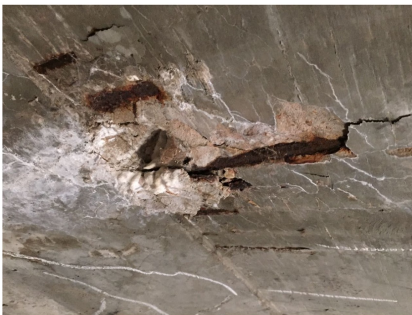
Figura 6 - Corrosão das armaduras, manchas e destacamentos do Concreto
