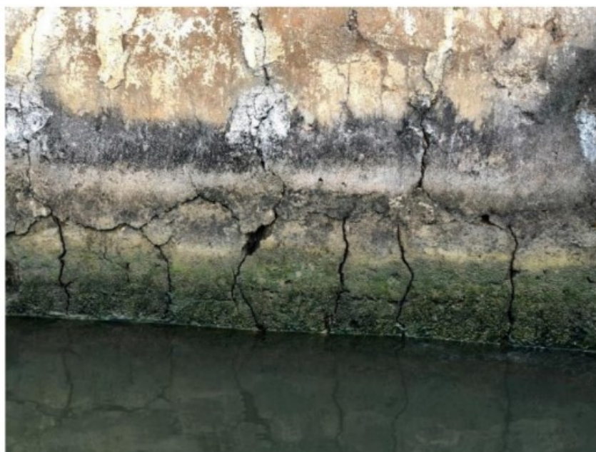
Figura 4 - Fissuras provenientes da reação Álcali-agregado
