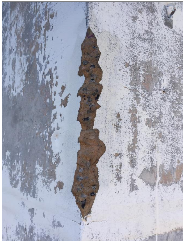
Figura 24 – RAP 001: PILAR DO RESERVATÓRIO – carbonatação do concreto (sem fenolftaleína)
