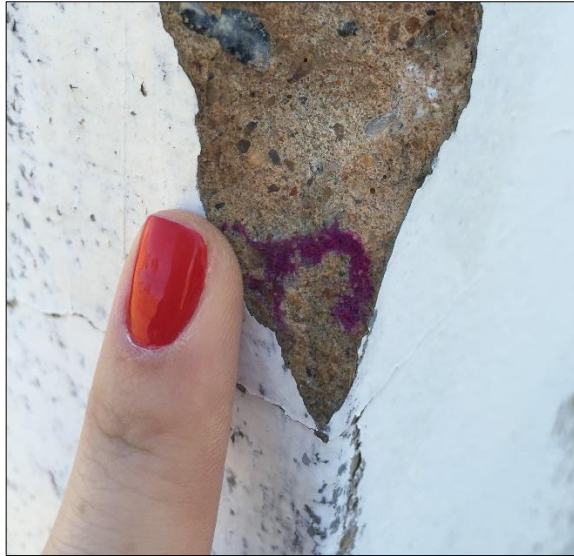
Figura 25 – RAP 001: PILAR DO RESERVATÓRIO – carbonatação do concreto (com fenolftaleína)
