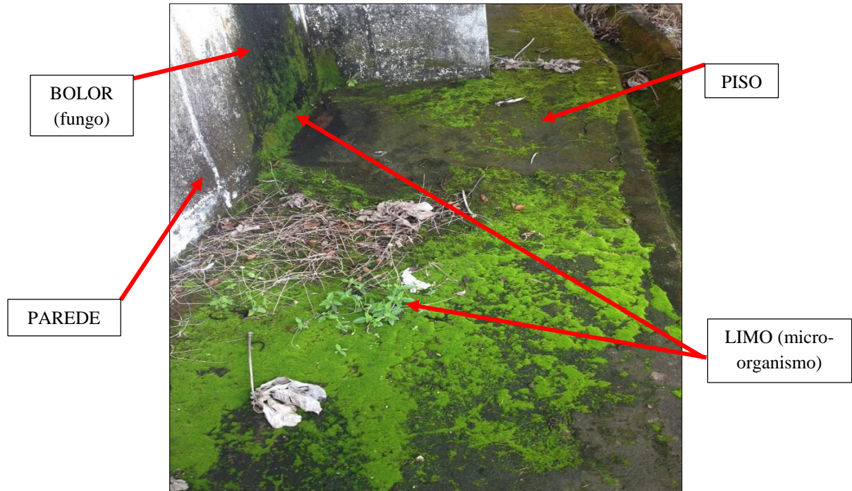
Figura 14 – RAP 002: PAREDE DO RESERVATÓRIO - limo
