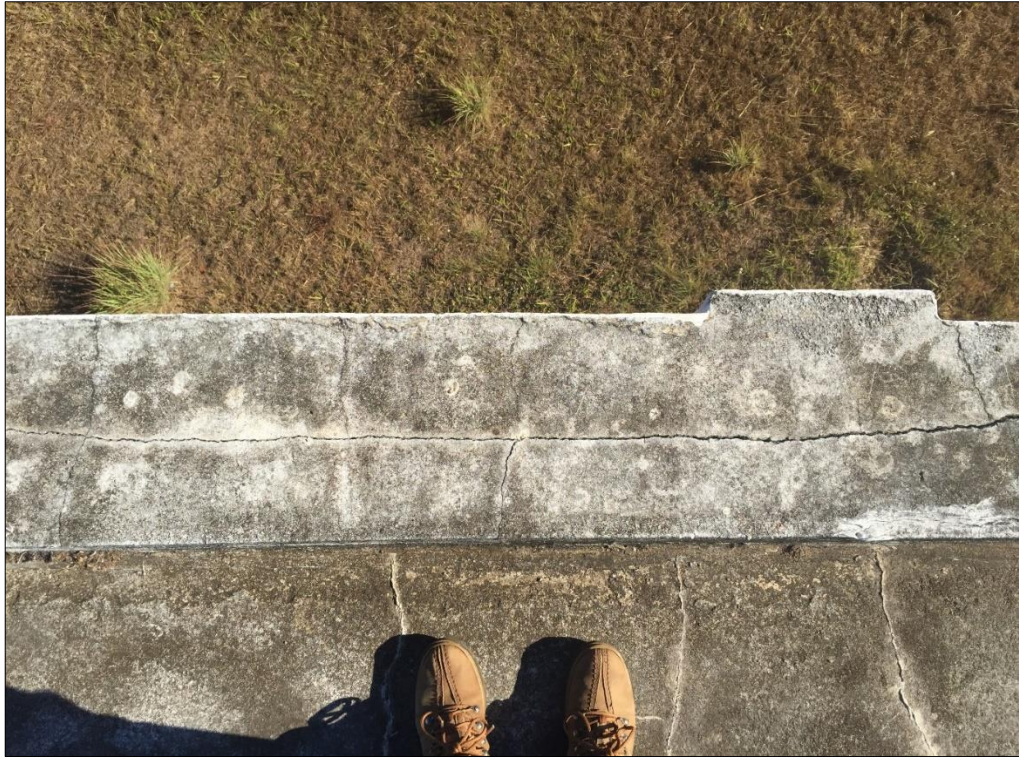
Figura 21 – RAP 009: VIGA DO RESERVATÓRIO - fissuras
