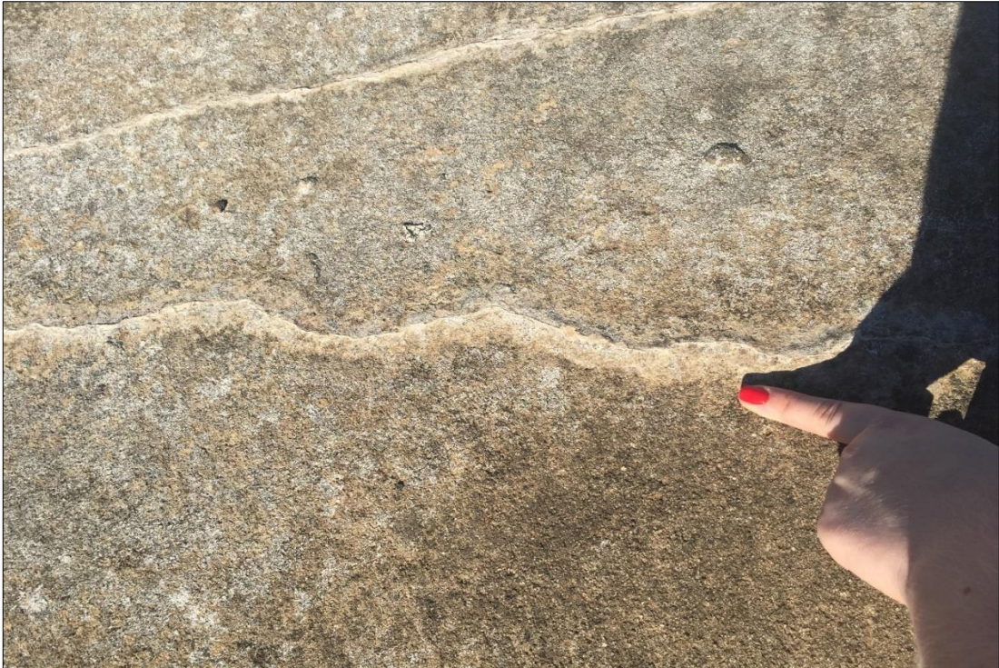
Figura 20 – RAP 009: LAJE DO RESERVATÓRIO - fissuras
