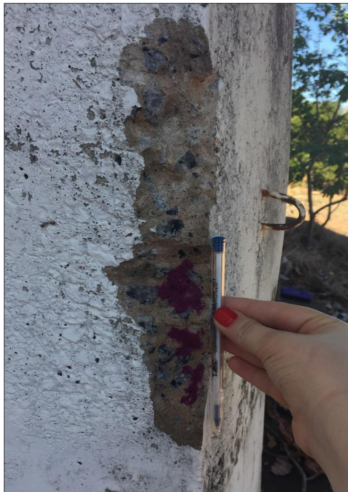
Figura 26 – RAP 002: PILAR DO RESERVATÓRIO – carbonatação do concreto
