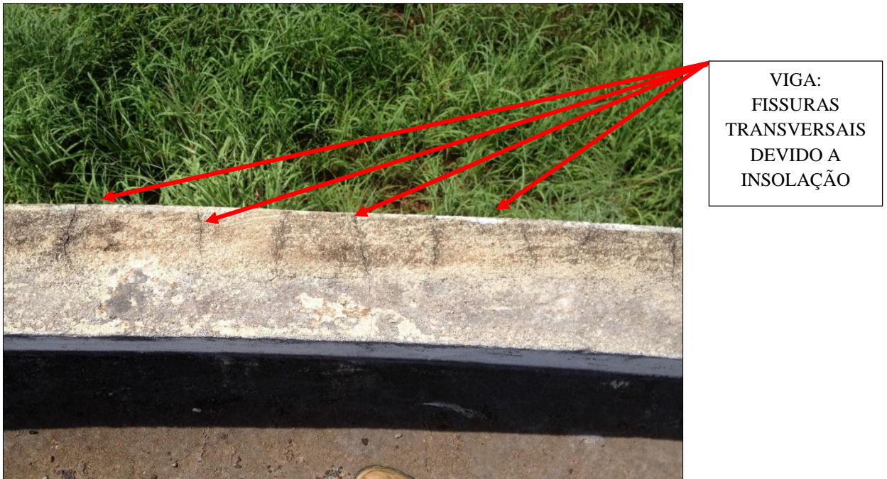
Figura 10 – RAP 001: VIGA DO RESERVATÓRIO – fissuras
