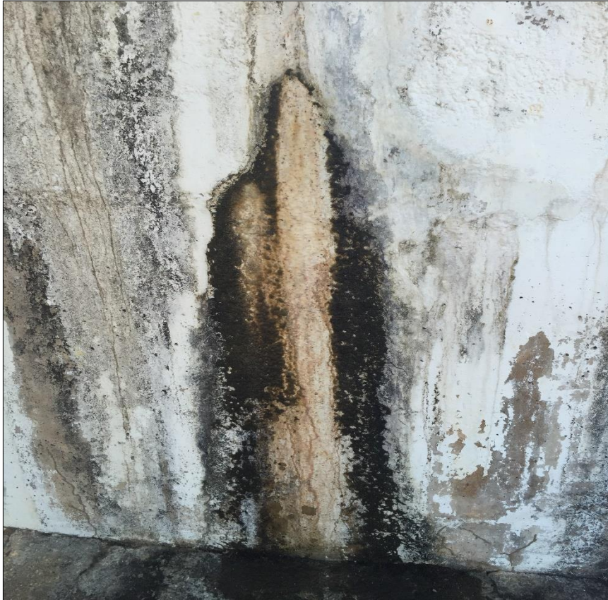
Figura 15 – RAP 002: PAREDE DO RESERVATÓRIO – bolor, eflorescência e corrosão
