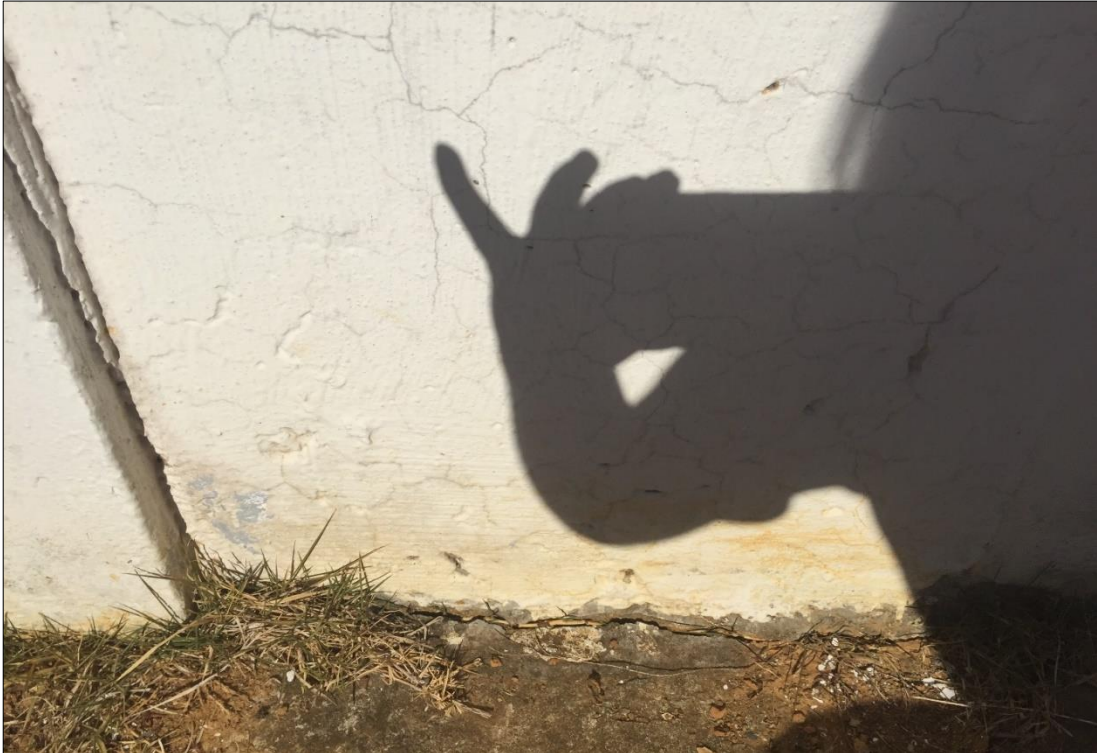
Figura 19 – RAP 0 9: PAREDE DO RESERVATÓRIO - fissuras
