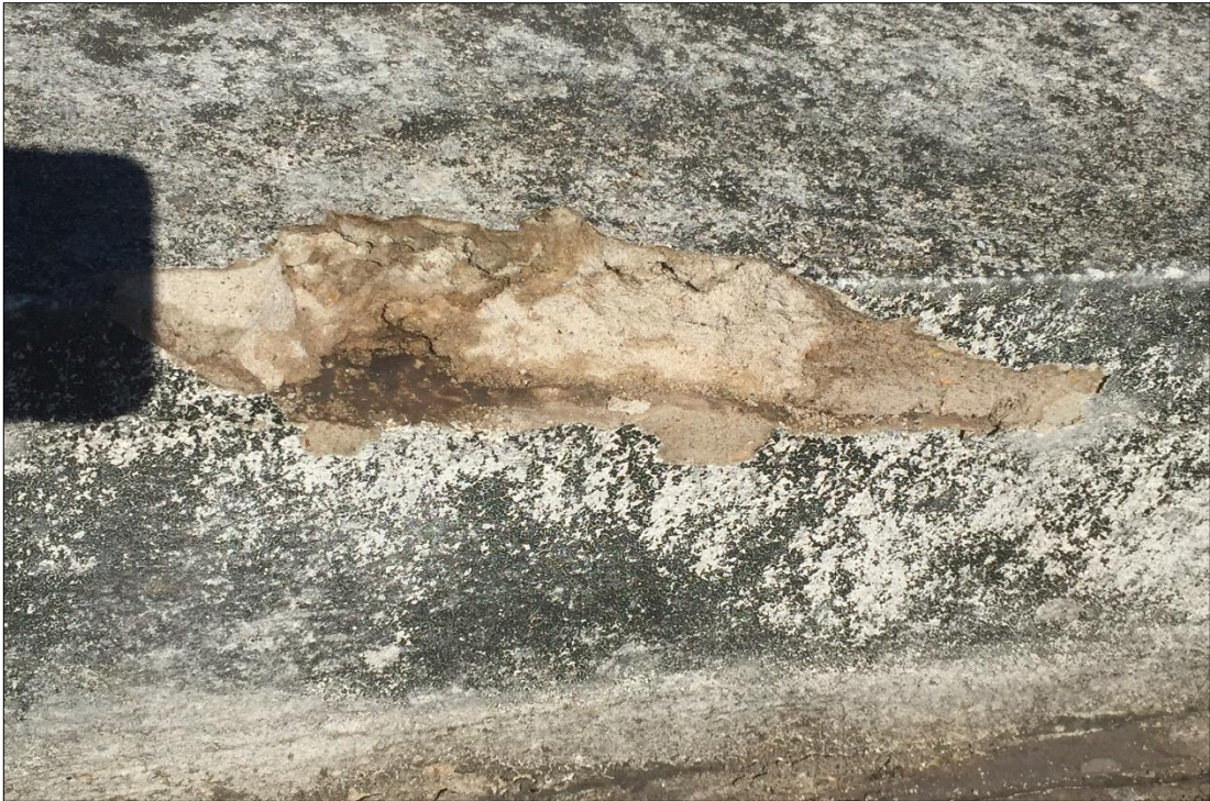
Figura 27 – RAP 009: VIGA DO RESERVATÓRIO – carbonatação do concreto
