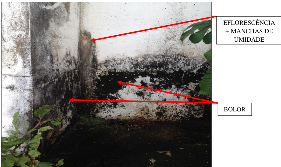
Figura 13 – RAP 002: PAREDE DO RESERVATÓRIO - bolor
