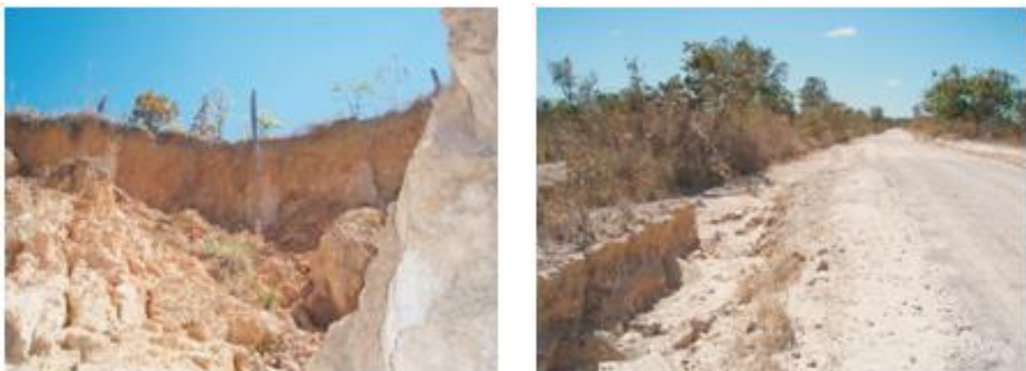
Figura 19 - Voçorocas decorrentes de más condições de drenagem Fonte: SRHMA
