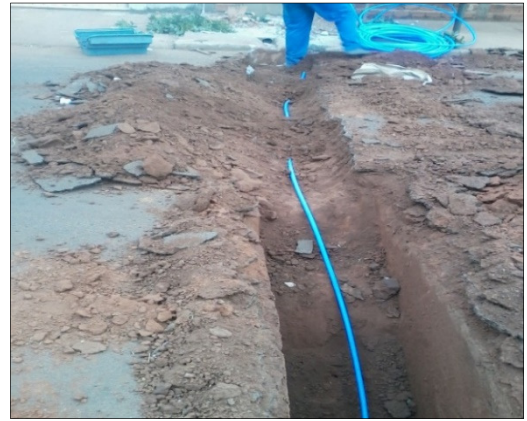
Figura 5 - Extensão de ramal em PEAD da rede ao hidrômetro. Fonte: Do autor (2015)
