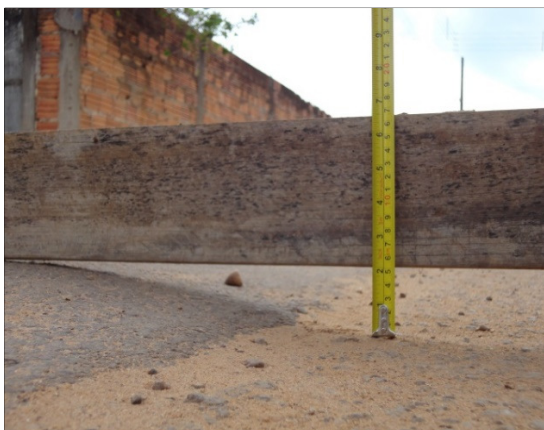
Figura 15 - Recalque em trechos repavimentados. Fonte: Do autor (2015)
