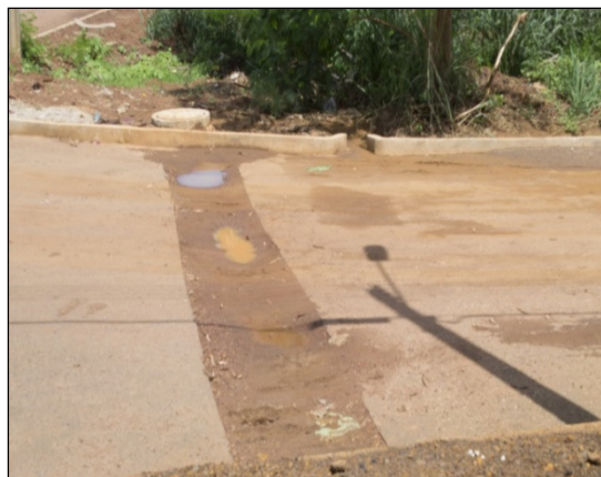
Figura 16 - Valas encharcadas sem pavimentação já com sinais de recalque. Fonte: Do autor (2015)
