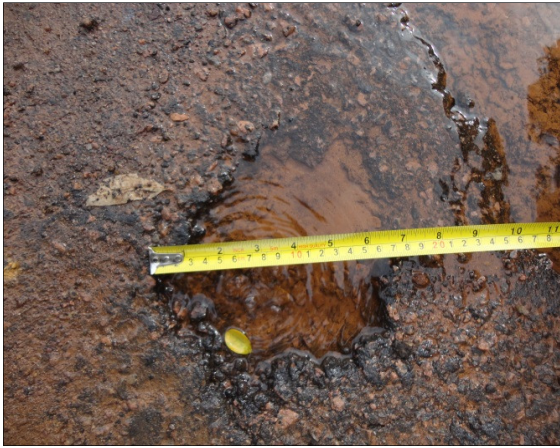
Figura 17 - Vazamento em colar de tomada do ramal de ligação. Fonte: Do autor (2015)
