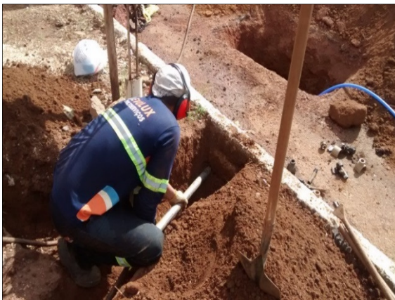
Figura 10 - Encanador lançando haste de perfuratriz através do furo de sondagem. Fonte: Do autor (2015)
