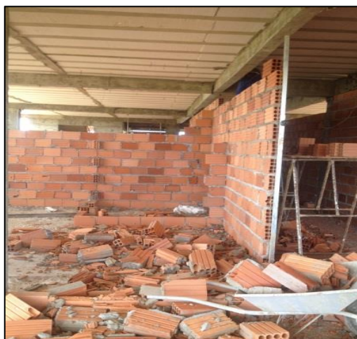
Figura 37: Queda de painel. Fonte: Autor, 2015.
