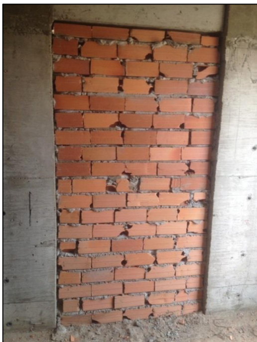
Figura 38: Tijolos defeituosos. Fonte: Autor, 2015.
