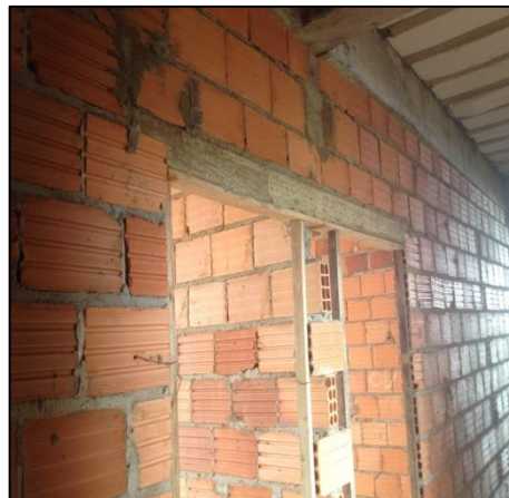
Figura 45: Verga executada errado.
