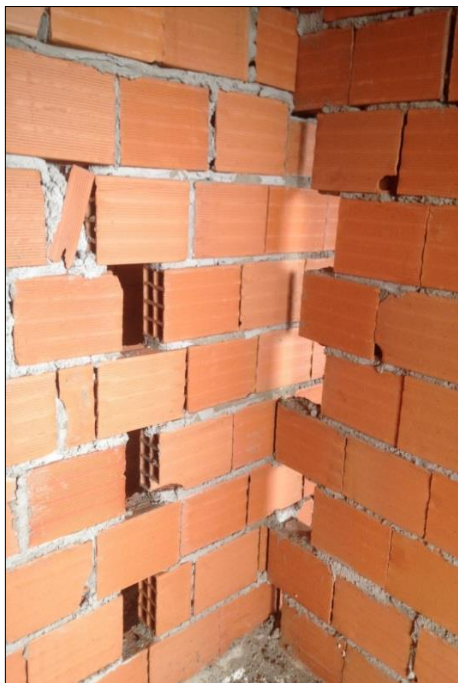
Figura 32: Parede não engastada. Fonte: Autor, 2015.
