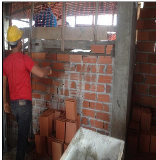
Figura 41: Lixiviação da argamassa. Fonte: Autor, 2015.
