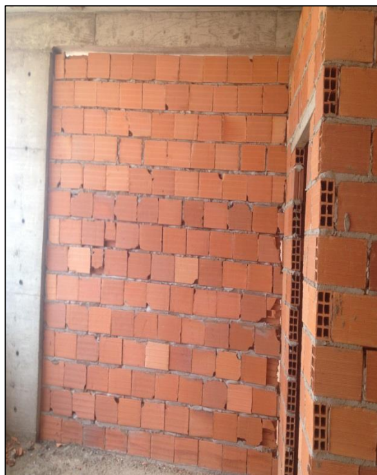
Figura 39: Muitas unidades de tijolos quebrados. Fonte: Autor, 2015.
