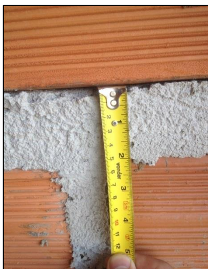
Figura 29: Junta de assentamento irregular. Fonte: Autor, 2015.
