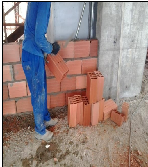
Figura 35: Falta de chapisco em pilares. Fonte: Autor, 2015.
