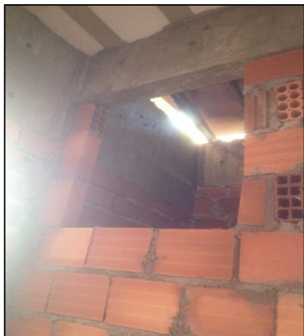
Figura 46: Painel sem a contra verga.
