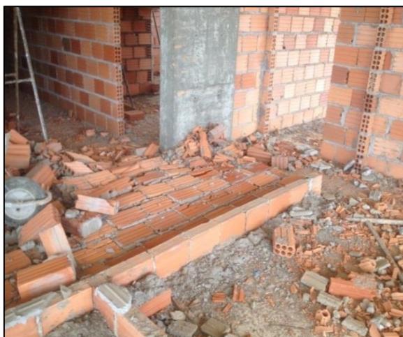
Figura 36: Parede caída. Fonte: Autor, 2015.
