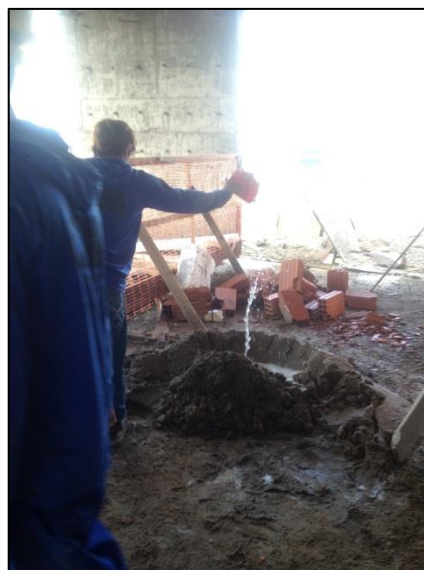
Figura 43: Falta de traço na argamassa. Fonte: Autor, 2015.
