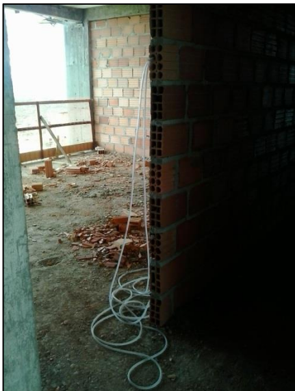
Figura 21: Mangueira, para verificação de nível. Fonte: Autor, 2015.
