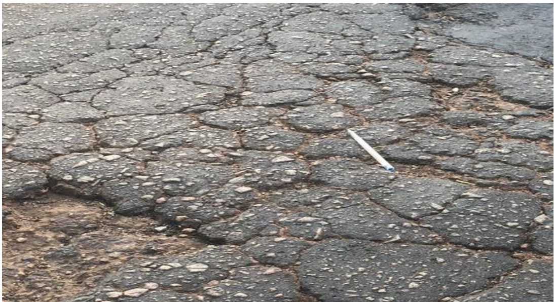
Figura 20- trincas tipo “couro de jacaré”
