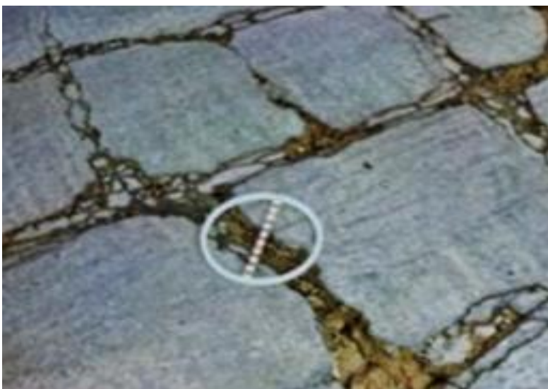
Figura 09 -Trinca em malha tipo bloco
