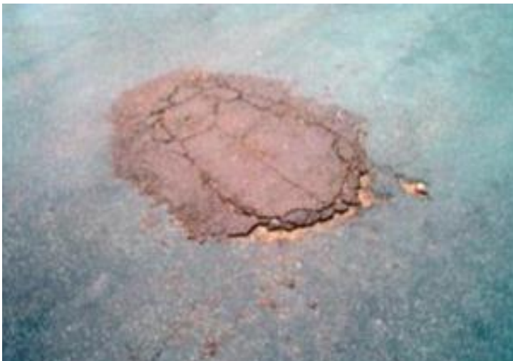
Figura 14 - Remendo mal executado
