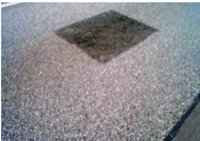
Figura 15 - Remendo bem executado
