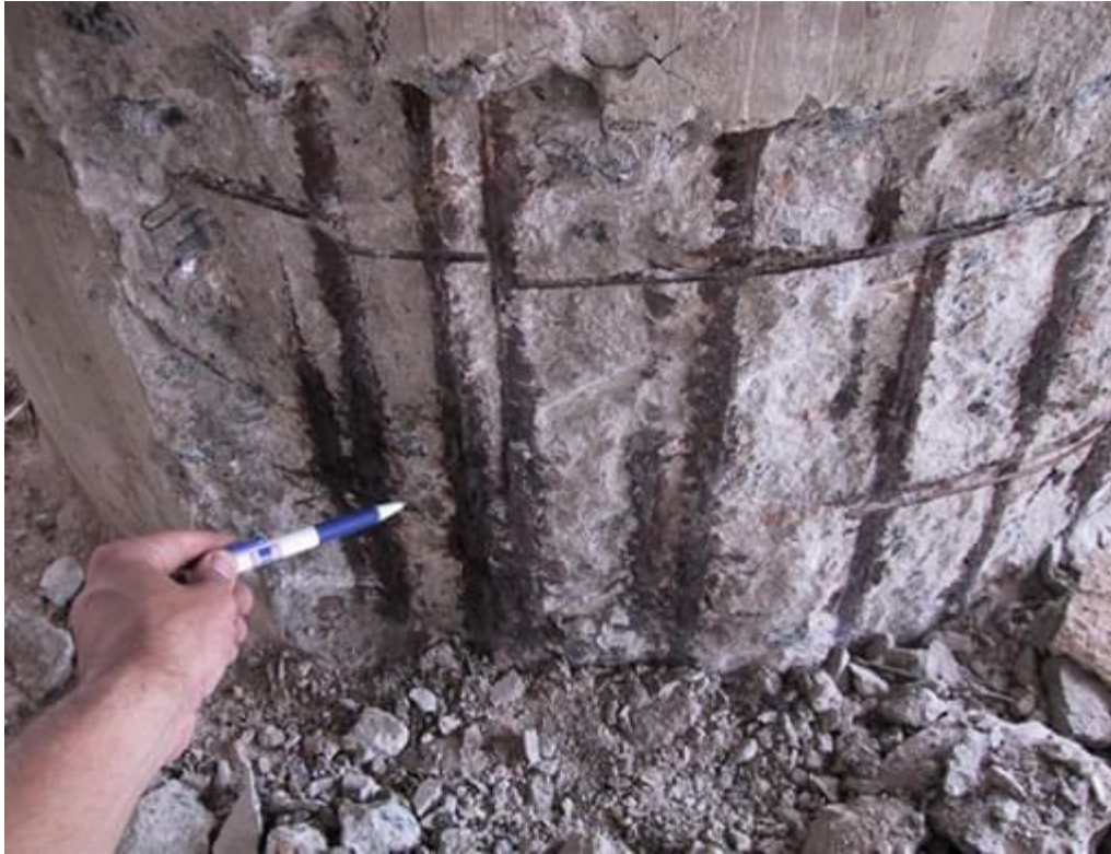
Figura 8 – Corrosão causa armadura exposta de um pilar
