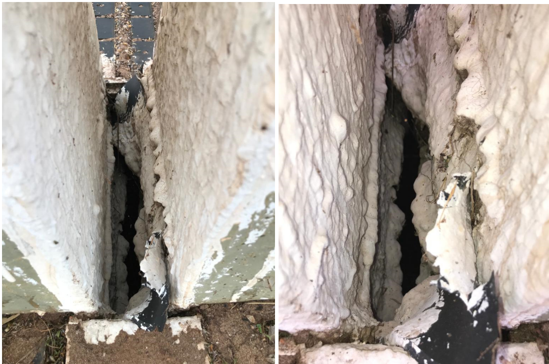
Figura 45 – Junta no guarda roda, sentido Norte-Sul.
