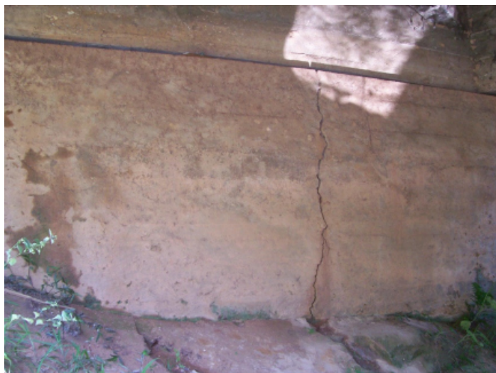
Figura 10 – Fissura de tração nos encontros
