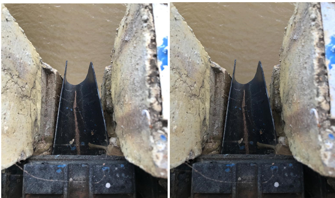
Figura 43 – Sistema de drenagem na junta 2, sentido Norte-Sul
