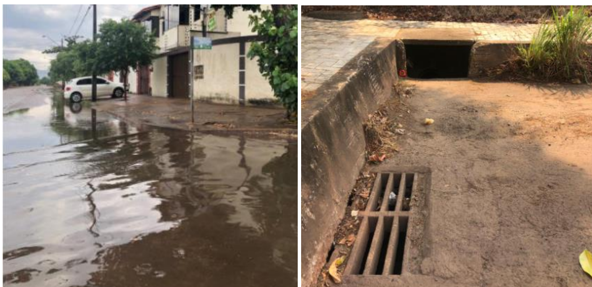
Figura 4 – alagamento das vias na quadra 504 sul e única boca de lobo da quadra
