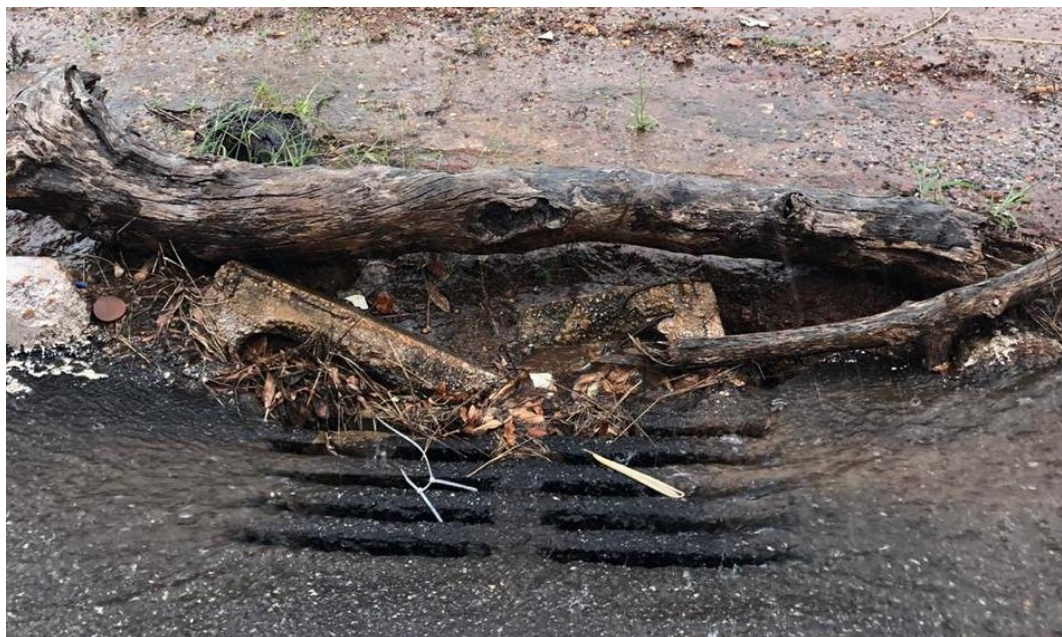
Figura 3 – Boca de lobo irregular.
