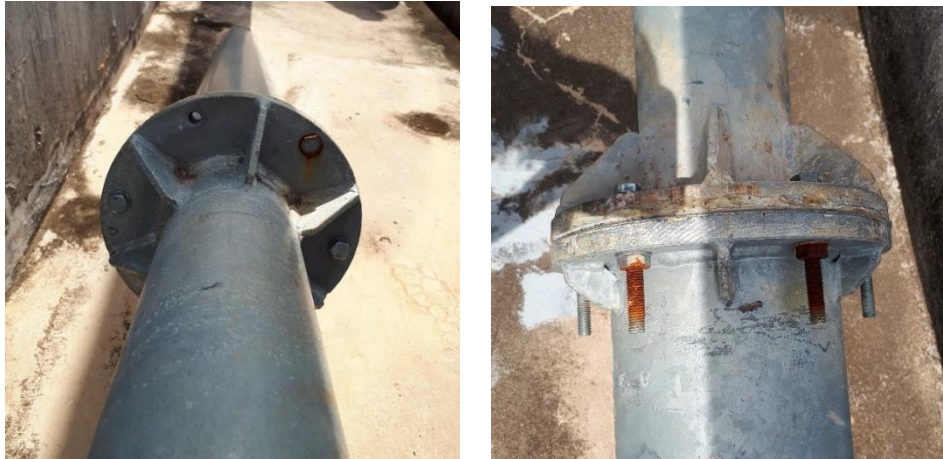
Figura 34 - Tubos antivandalismo com danos
