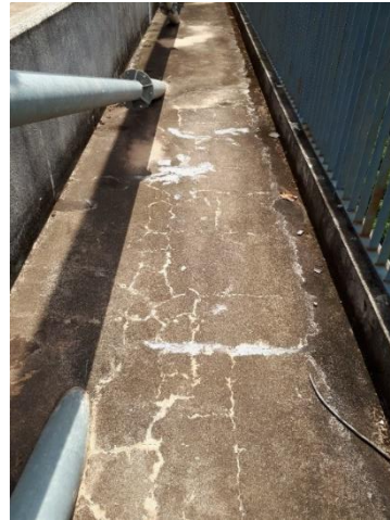
Figura 27 - Fissuração próxima aos estais
