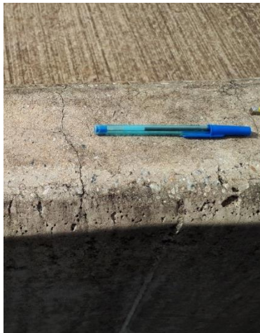
Figura 28 - Fissuras na barreira de proteção
