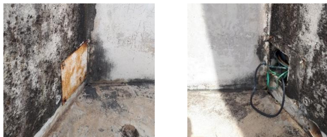
Figura 40 - Caixas de passagem de tubulação de energia
