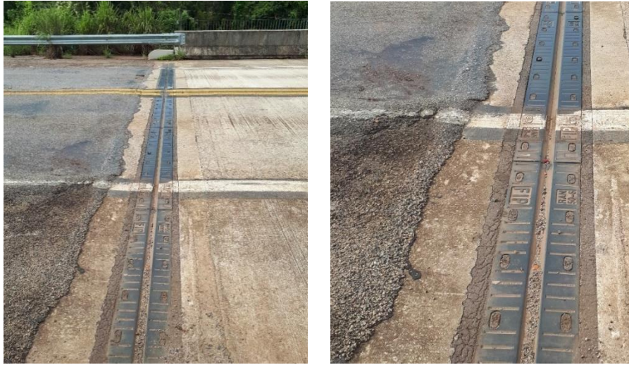
Figura 21 - Junta entre acessos e a ponte
