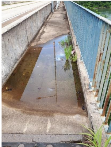
Figura 26 - Acúmulo de água no passeio
