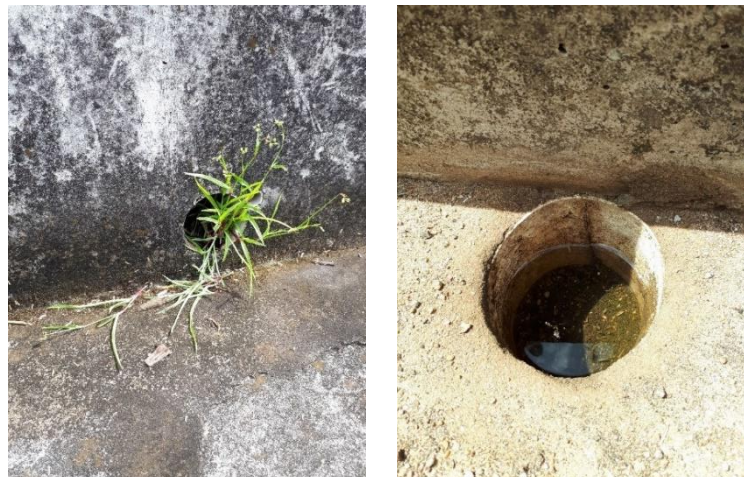
Figura 31 - Dispositivos de drenagem obstruídos
