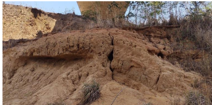
Figura 46 – Talude com processo erosivo
